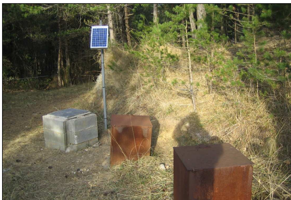
Figura 22. Emplazamiento de tres sondeos, correspondientes a extensómetro, inclinómetro y piezómetro, así como una placa solar que sirve de fuente de alimentación.
