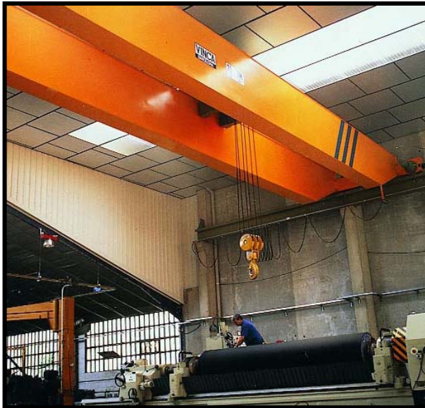
F.8.9: Puente grúa
