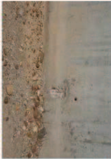
FOTO N° 26: Detalle de la base de la columna del viaducto con arena suelta en base de la columna del lado de la pile 7
