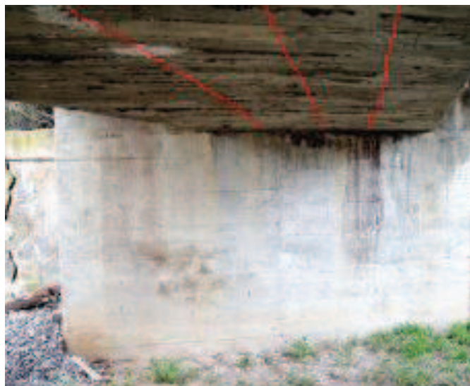
Fig. 11 - Fissures longitudinals a la losa d'un pont
