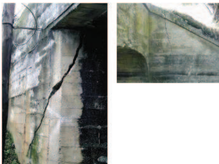
Fig. 30 - Fissures inclinades en estreps
