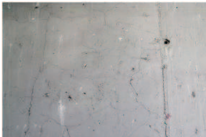
Fig. 41 - Fissures per la calor d'hidratació
