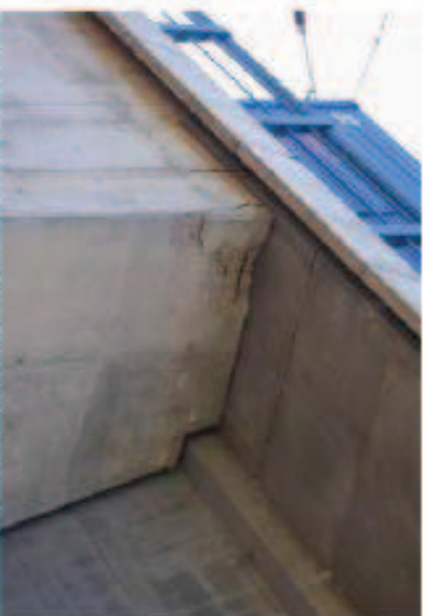
FOTO Nº 12: Vista detallada del deterioro localizado en vertice superior izquierdo del estero norte.
