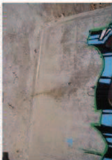
FOTO Nº 22: Fissura irregular amb tirador al davant de la cara superior de la pla 5.
