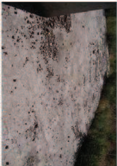
FOTO Nº 21: Fissures irregulars entre sí de cara superior de la placa 4.
