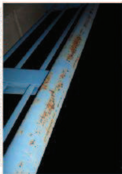
FOTO Nº 3: Deterioració dels tancos en zones de separació.
