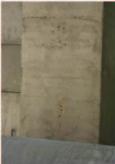
FOTO Nº 88: Desconexión con armadura visible en cara interior de la viga de la viga 54. (V. de vialto al 8000 3000 018 53)
