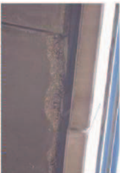
FOTO Nº 15: Detalle de rotura en grietas como grúmas al estribo sur. Armadura vista / oxidada desde la inspección por el muro.
