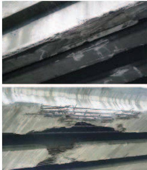
Fig. 47 - Efectes de l'impacte de vehicles en passos inferiors degut a problemes de gàlib
