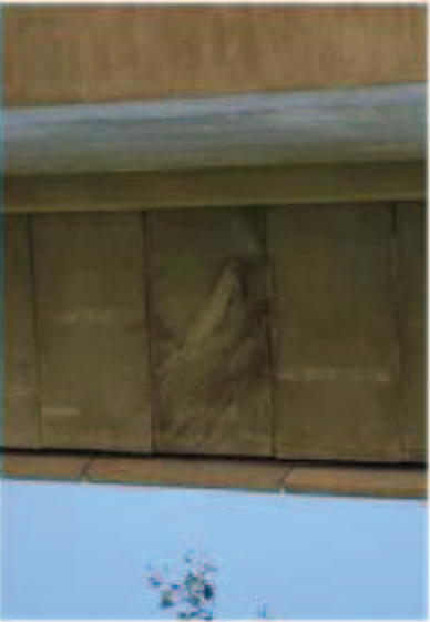
FOTO Nº 80: Fricciones por encimbre de losa de cara sur. Vialto de vialto de vialto 57.
