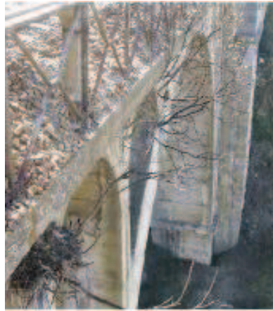
Fig. 59 - Exemple de vegetació arrelada a l'estructura
