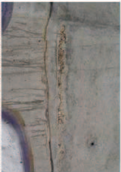
FOTO Nº 24: Segregació de ciment en la cara superior de la pla 7.
