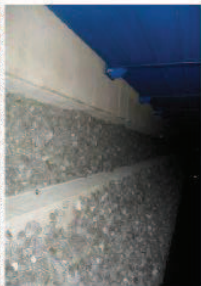
FOTO Nº 2: Cotes de drenatge acumulades en el terra de la plataforma.
