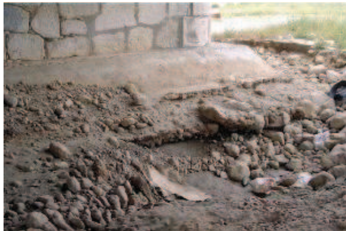
Fig. 9 - Exemple de soscavació en pila
