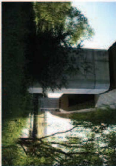
FOTO Nº 62: Vista desde el sur de las pilas 23 y 24. Dirección sección trasversal. Piles situadas a unos 500m del río Júcar.
