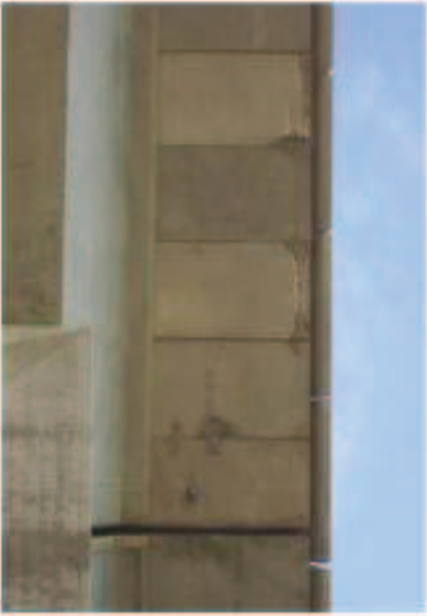
FOTO Nº 36: Fijuras longitudinales en pilares de vano como pilares de la vía 17.
