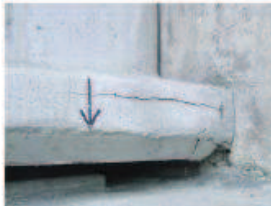
Fig. 19 - Fissuració horitzontal induïda per l'empenta d'un mur
