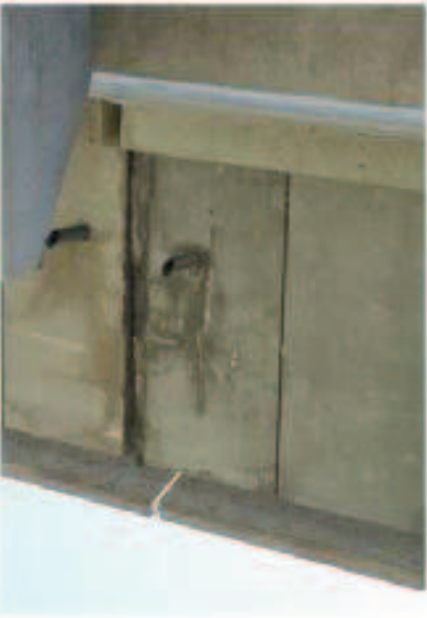
FOTO Nº 64: Fijación de armadura y conglomerado con fisuras en los bordes del vano como punto a la pila 23.
