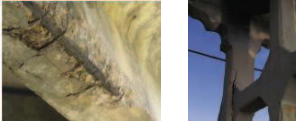
Fig. 62 - Exemples de corrosió per clorurs
