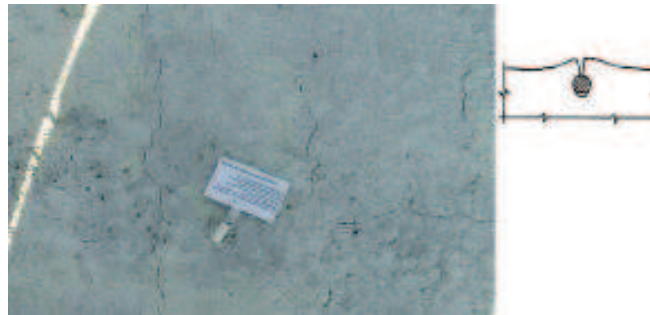
Fig. 39 - Fissures per assentament plàstic
