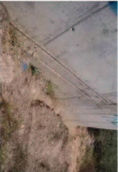
FOTO Nº 18: Erosión en trazo de cara sur con.
