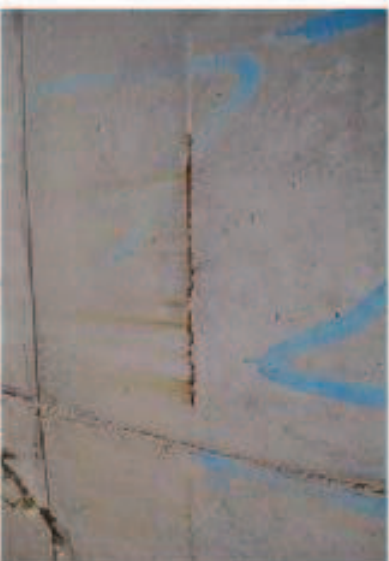
FOTO Nº 66: Amasada vista por la de recubrimiento en los bordes del vano de la pila 46.
