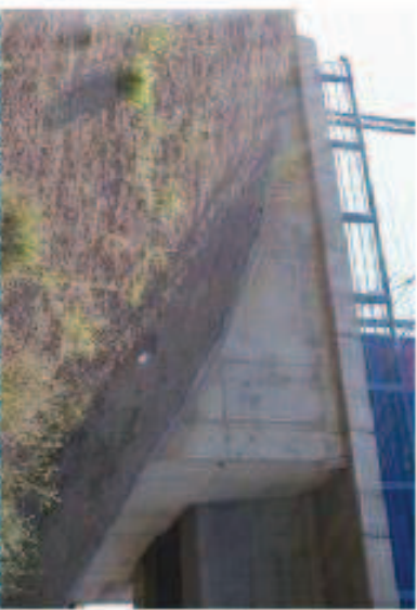
FOTO Nº 11: Vista general de la zona norte. Sin otros cerrados. Se aprecia el deterioro con cerrados en todo el sector.
