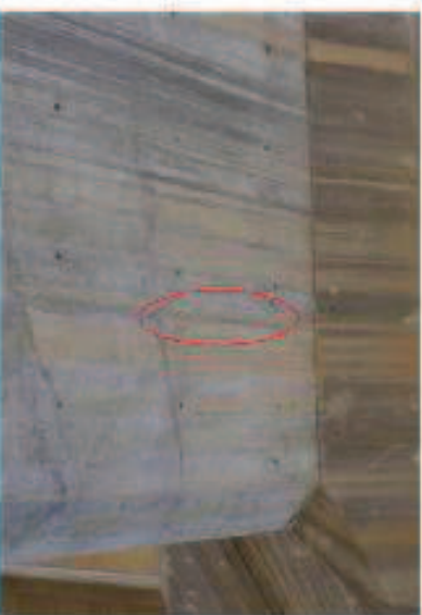
FOTO Nº 81: (vialto 2000) 20 018 53 en cara norte de la viga 55.
