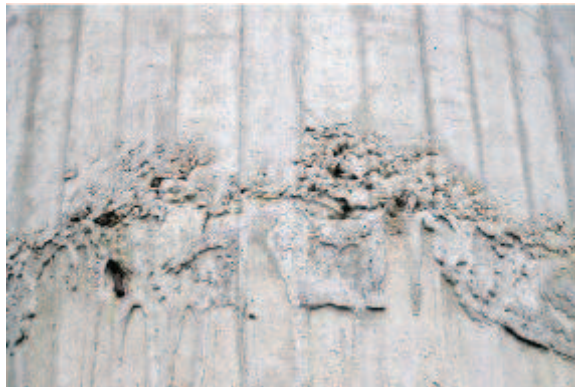
Fig. 35 - Pèrdua de beurada i fins en una junta d'un pilar
