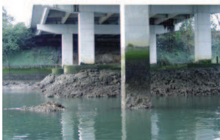
Fig. 2 - Pèrdua d'element de protecció en una pila
