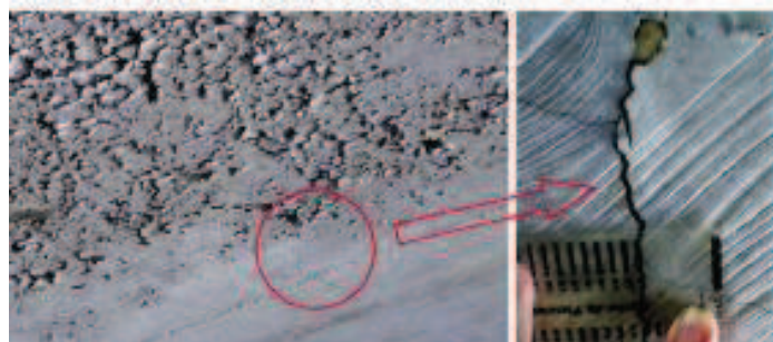
Fig. 37 - Exemple de nius de grava i desagregació
