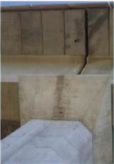
FOTO N° 29: Amadura vista por la base de la reparación en la pile 12. Protección personalizada por juntas del soporte.
