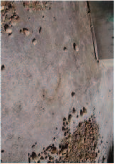
FOTO Nº 23: Fissures irregulars entre sí en cara superior de la placa 5.
