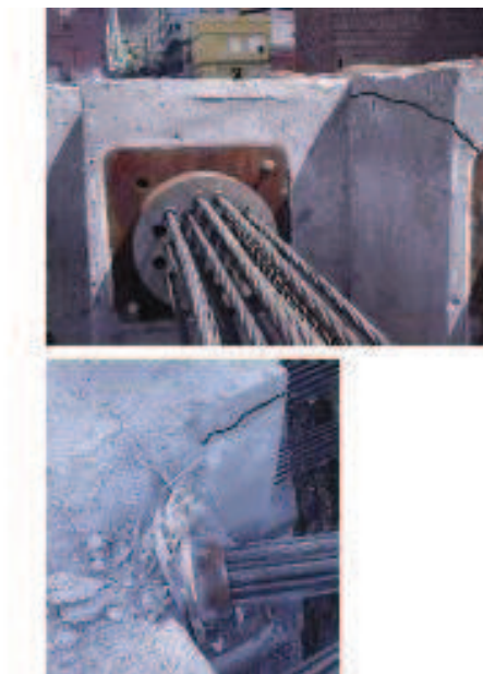
Fig. 18 – Fissura horitzontal en cap d'ancoratges
