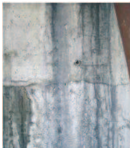
Fig. 29 - Fissures horitzontals creades per juntes que no estan ben formigonades
