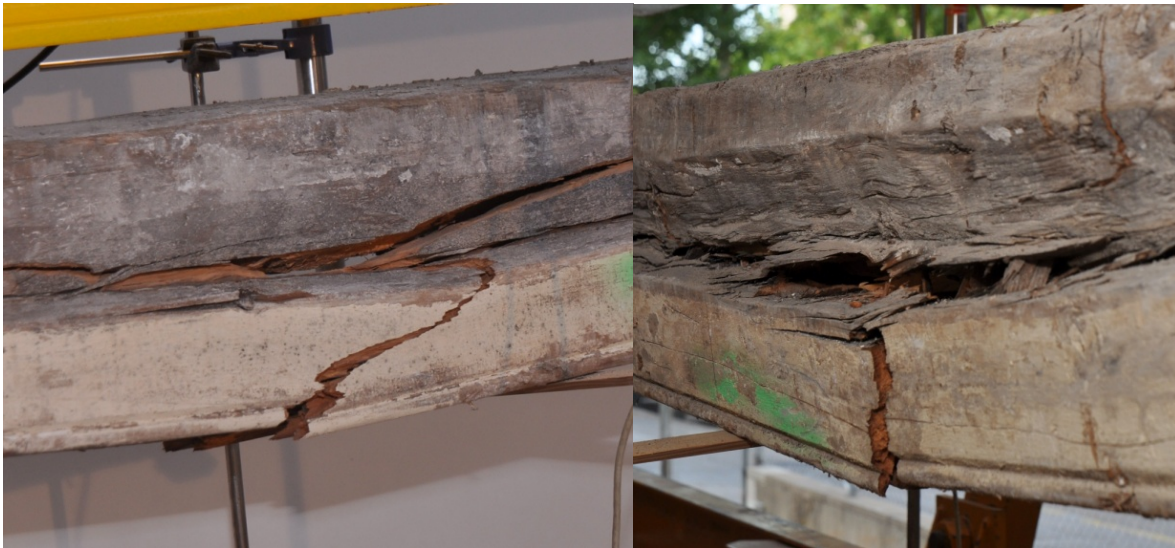
Il·lustració 81: Diferents ruptures de bigues
