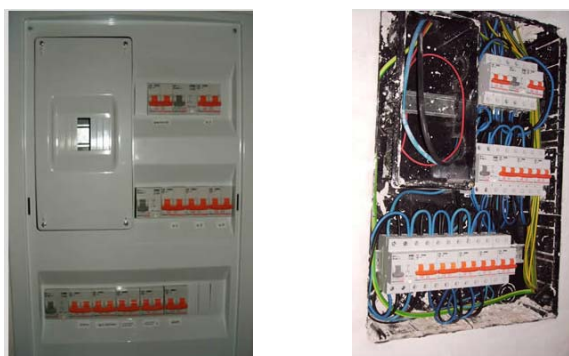
Figura 5.3. Imatge d'un quadre d'electrificació elevada amb l'allotjament per l'ICP. Cablejat del quadre anterior. [7]
