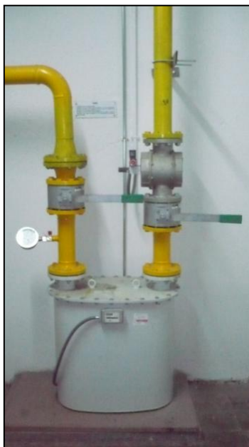
Figura 22 Comptador de gas de la instal·lació de l' edifici VG123
