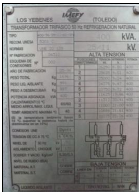
Figura 21 Placa de característiques del transformador del CT
