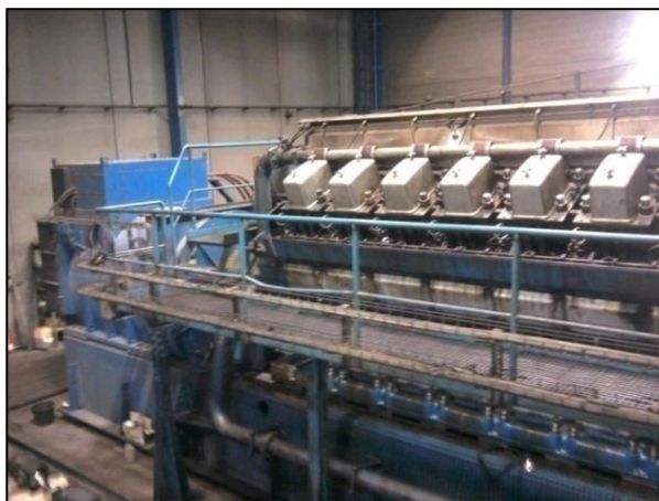
Figura 5 Motor de cogeneració Wärtzila Bassa 7.3 MW
