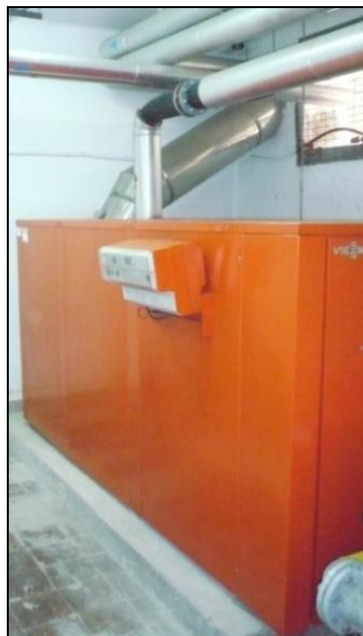
Figura 23 Caldera Viesman edifici VG123
