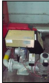
Figura 24 Cremador Roca de la caldera
