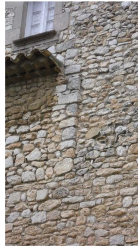
4.8. Junta de façana que uneix la part construïda al s.XVIII i la posterior.
