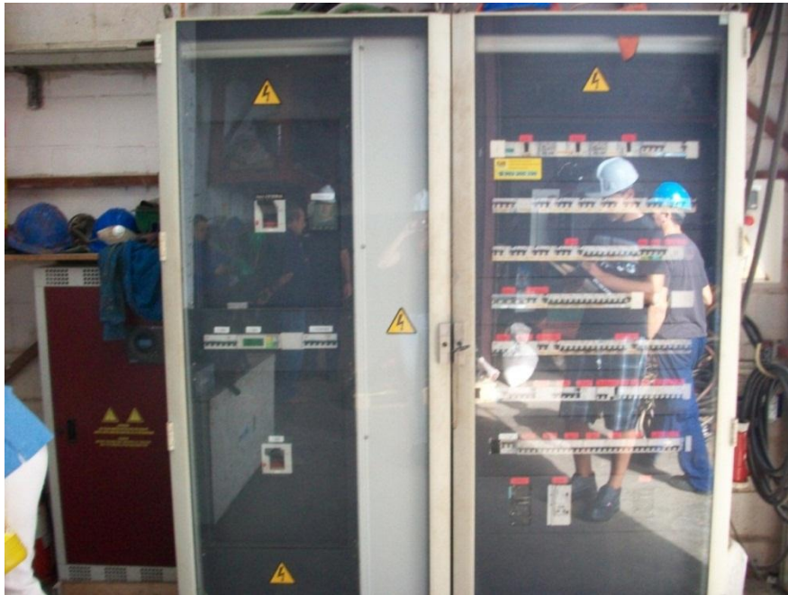
Imagen 35: Cuadro eléctrico principal
