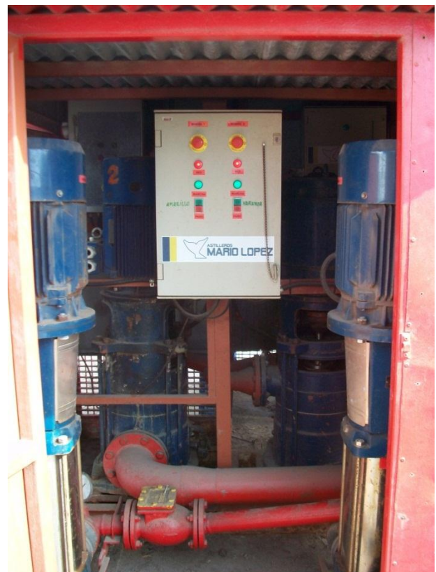
Imagen 25: Bombas de presión y caudal del sistema de agua salada.
