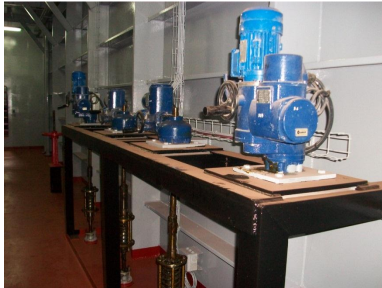
Imagen 44: Piano de válvulas
