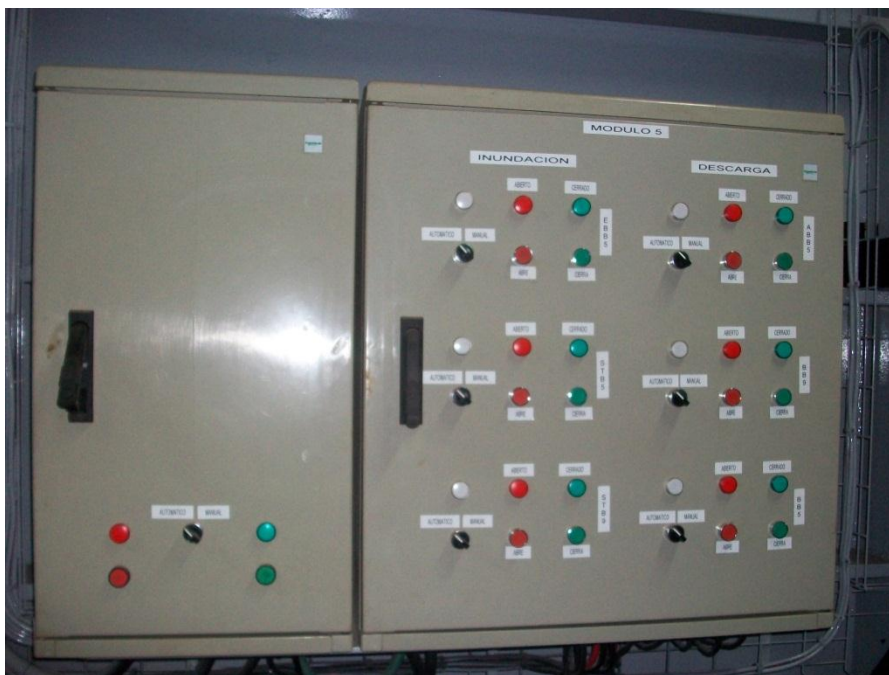
Imagen 319: Cuadro eléctrico de un módulo
