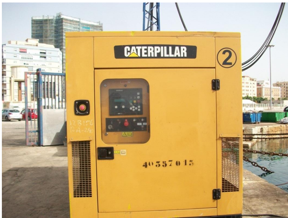
Imagen 36: Generador de corriente a 60 Hz.
