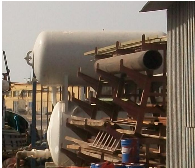
Imagen 28: Depósito de aire comprimido
