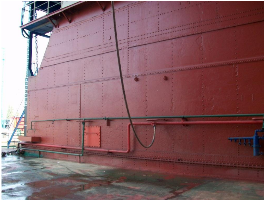
Imagen 261: Sistema de tubería del dique flotante
