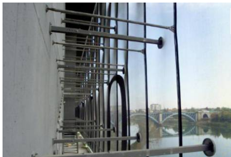
Img.61 Fachada Textil del Teatro Nacional de Maribor – Eslovenia. Fuente Fotografías Catálogo Stamilol FT. Las barras horizontales que separan las dos pieles son elementos rígidos parte del sistema estructural, los cuales permiten contrarrestar los empujes horizontales. Las barras Tubulares por el centro de la malla trabajan a compresión.
