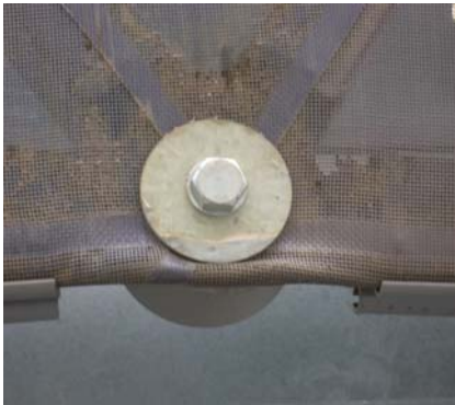
Textil con partículas externas acumuladas en el tejido que denotan suciedad y corrosión en las conexiones con la estructura.
