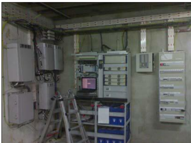
Fig. 2.6. Interior caseta estación base común [10]
