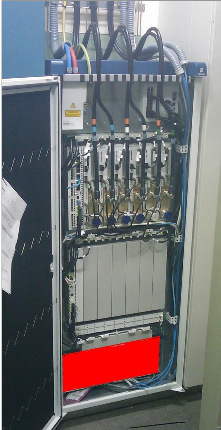
Ressaltat en vermell - Espai destinat a transmissió en una RBS6201 d' Ericsson
