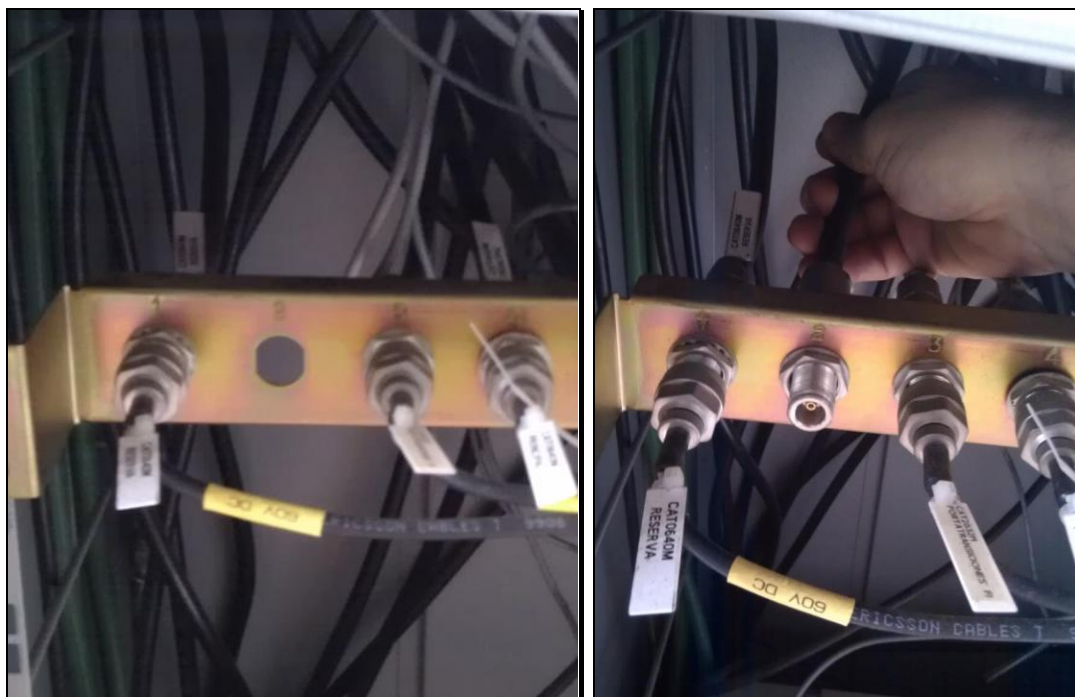
Rack interconnexió RG-8 IF. Aprofitem l'espai lliure per muntar la transició
