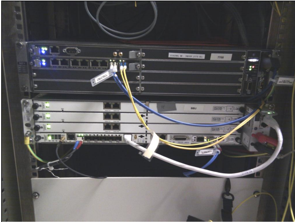
Alcatel-Lucent LTE muntat a la Fira de Barcelona
