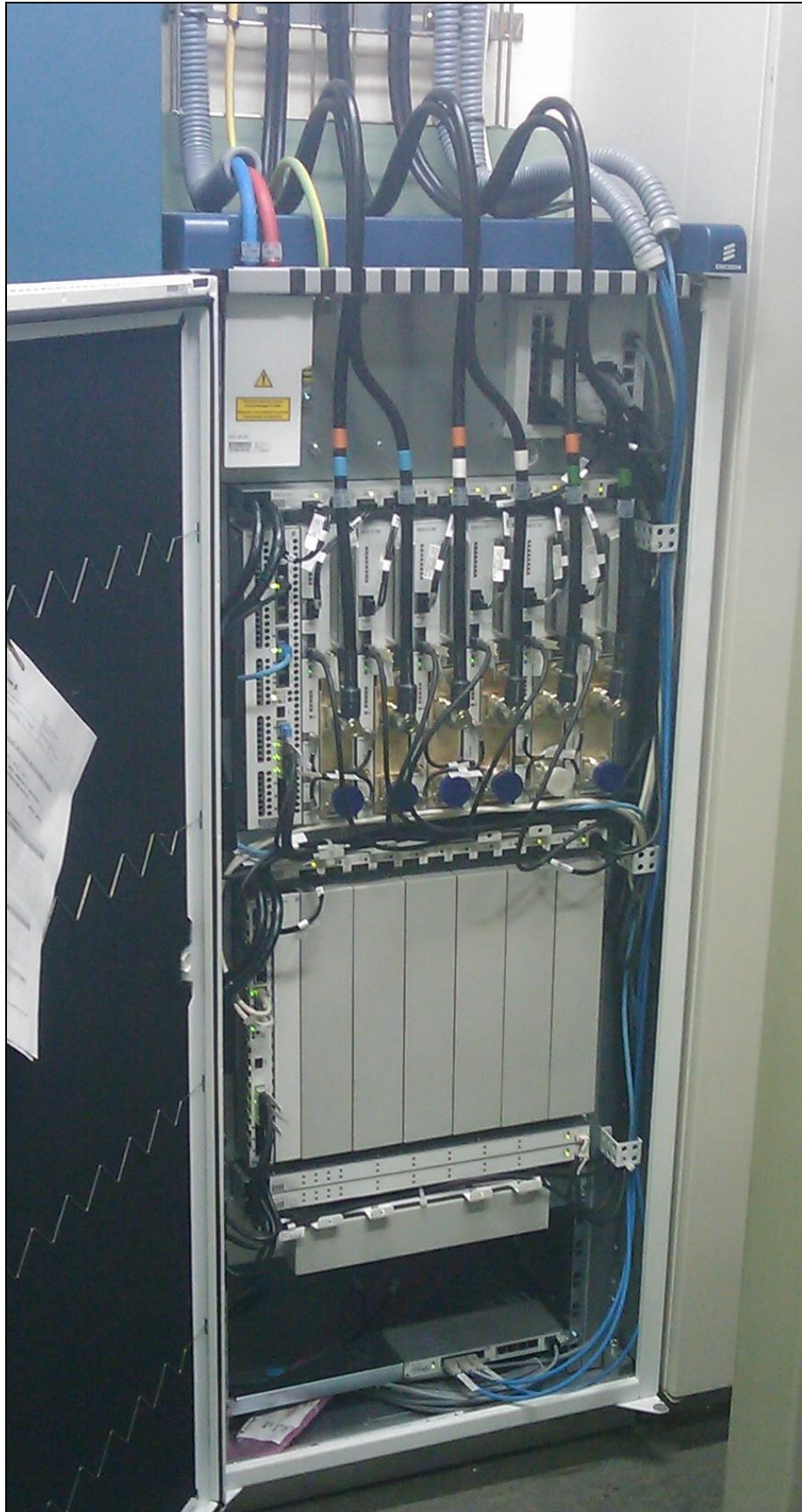
RBS 6201. Configuració: GSM/UMTS-900 3 sectors. Sistema Radiant compartit
