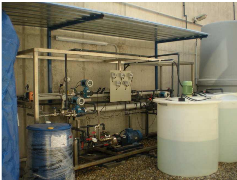
Figura 8.3. Fotografía de la planta piloto de Nanofiltración.
