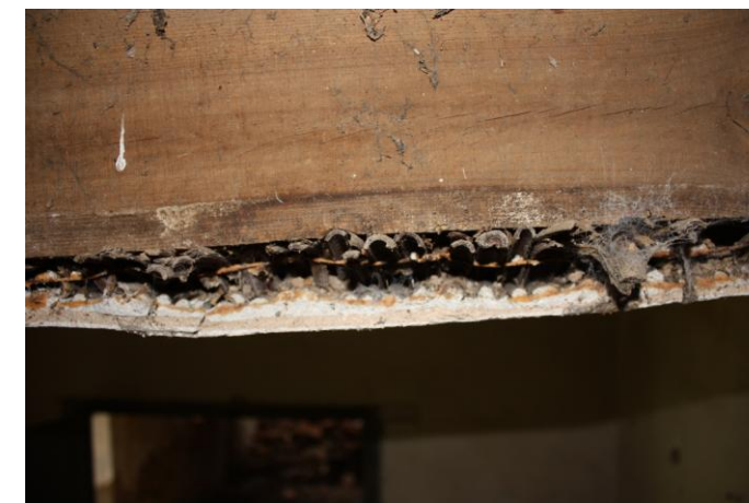
40.- Sección del falso techo donde se observa el cañizo y el acabado de mortero de cal.
