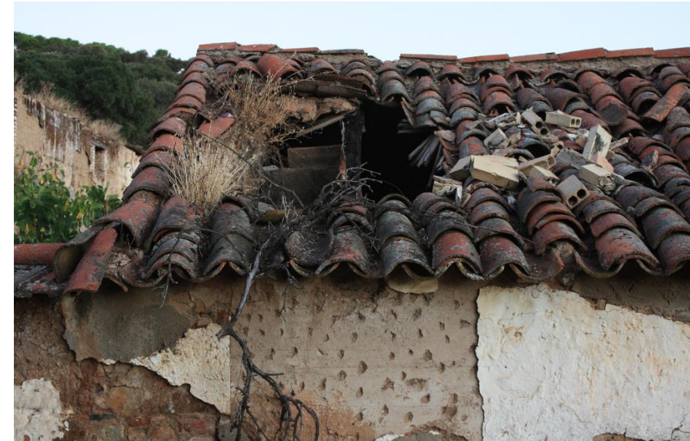
73.- Desprendimiento del saliente de la chimenea en la vivienda principal.
