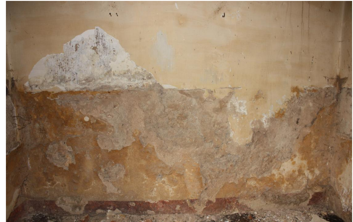
59.- Muro interior de la vivienda principal donde se puede ver la presencia de la humedad por capilaridad hasta una altura de 1 metro.
