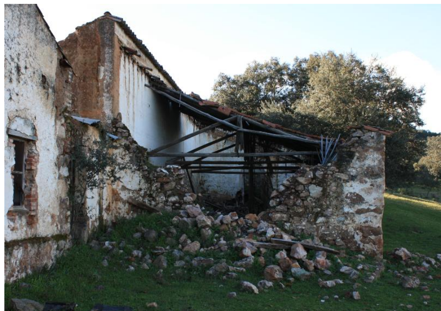
61.- Colapso total del muro que alberga ala entrada a las cuadras exteriores.
