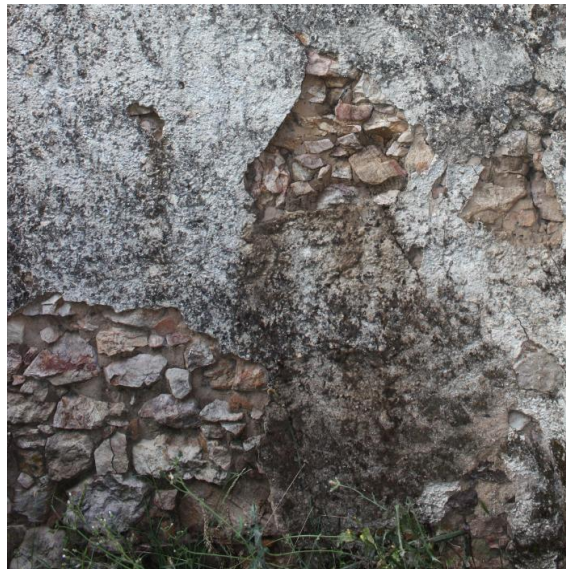
29.- Desprendimiento del revestimiento que deja al descubierto el muro de piedra de la vivienda principal.
