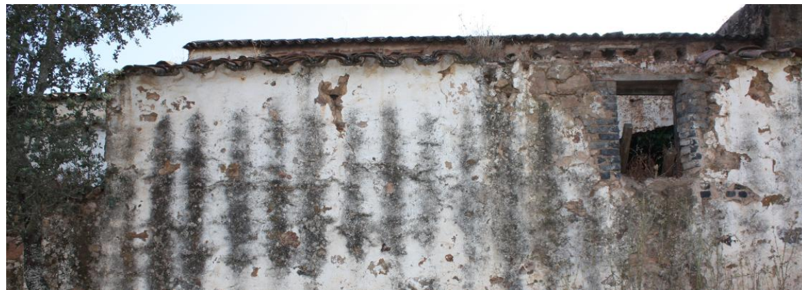
65.- Suciedades por lavado diferencial en el revestimiento de mortero de cal en la fachada noreste.
