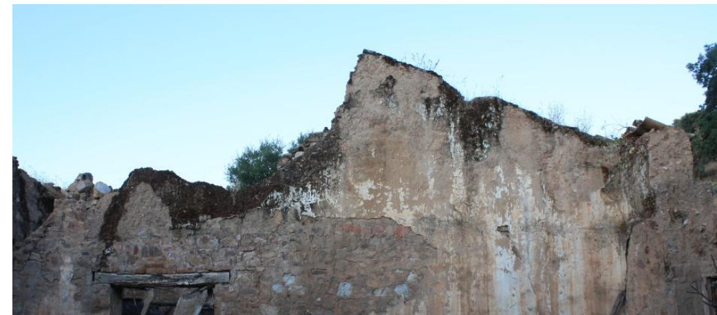
67.- Musgo en los tramos superiores del muro tapial que separa la sala tinajera de la sala de maquinaria de la uva.
