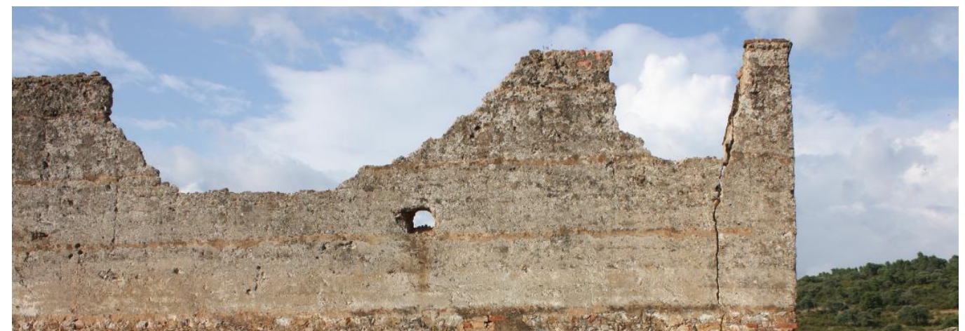
63.- Caídas parciales del muro tapial en la fachada suroeste.
