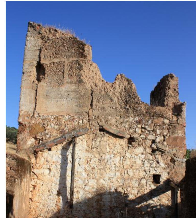
69.- Grietas en el muro tapial y que continúan por el muro de piedra.
