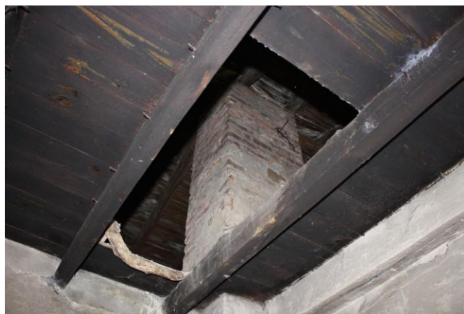
39.- Imagen que muestra un hueco en el falso techo formado por un entablado por la parte superior de las vigas de madera.
