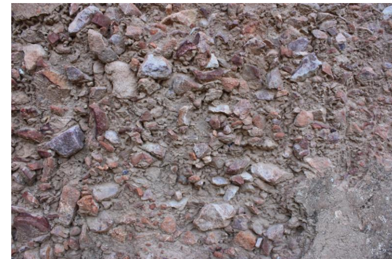
31.- Imagen que muestra un tramo sin revestimiento de muro tapial, dejando ver los elementos que lo forman.
