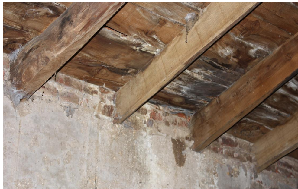
72.- Presencia de manchas grisáceas que delatan la presencia de humedades en las tablas.
