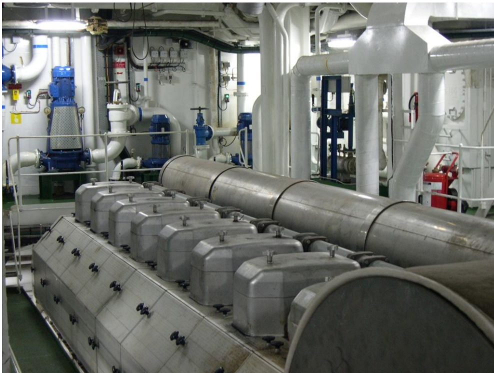
Vista del Motor principal Wärtsilä des del pis intermedi de la Sala de Màquines.
