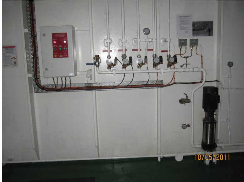
Equip d'accionament del sistema flexifog dispostat al local del servo.
