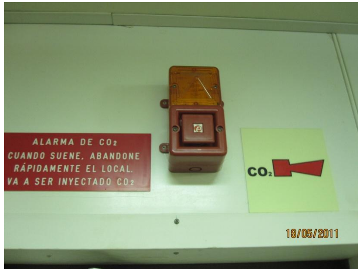
Indicador d'alarma, alarma i instruccions en cas d'injecció de CO2 al control de màquines.
