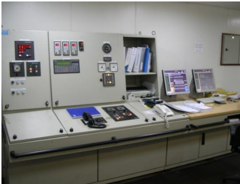
Equips electrònics de control de la màquina.
