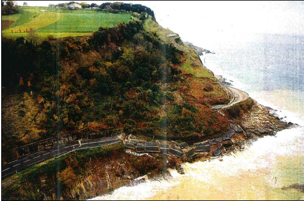
Figura 5-12. Lliscament d'uns 30.000 m 3 succeït el desembre de 1998 a l'entorn del P.K. 23+900, afectant un tram de carretera de 200 m. Font: Ikerlur.
