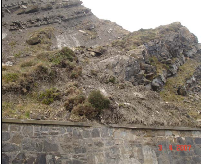
Figura 5-17. Foto que mostra l'esllavissada, originalment localitzada al P.K. 25+700.
