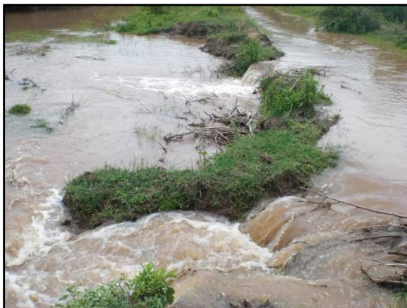
Fig.31: Fotografia del marge dret del canal de Corral Quemado al seu pas pel paraje de San Benito. S'aprecia el desbordament del canal a causa del trencament del marge, per on es perden grans quantitats de cabal.
