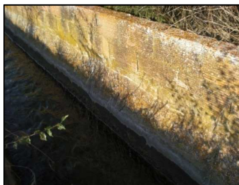
Fig.36. Canal revestit de maons a la població del Rourell, província de Tarragona (Catalunya).
