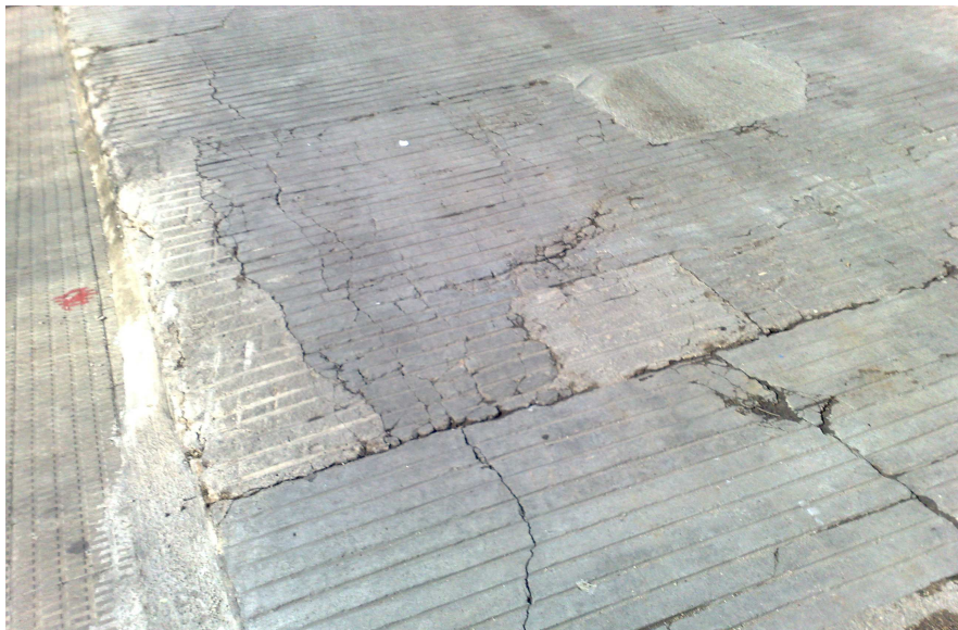
Foto 7. Apreciamos el mal estado de los suelos y las rampas, las cuales presentan grietas extensas y resquebrajamiento. No se pudo comprobar en ningún momento la existencia de suelos antideslizantes.
