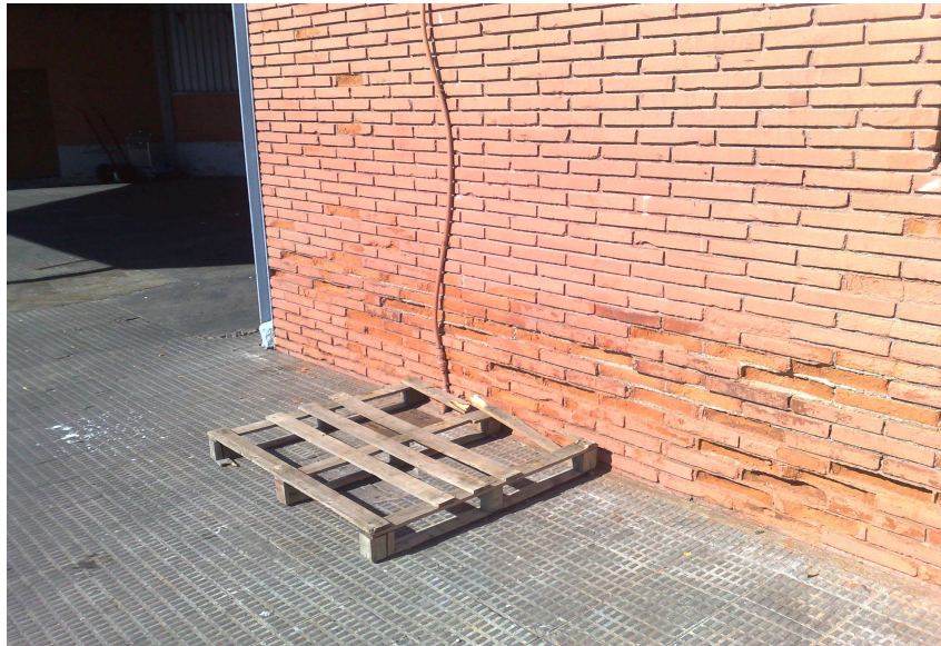
Foto 1. Se puede apreciar el mal estado de las paredes y su suciedad. Al mismo tiempo, se visualiza la deficiente fijación del cable eléctrico. No se pudo comprobar la existencia de extintor alguno en ninguna parte del muelle.
