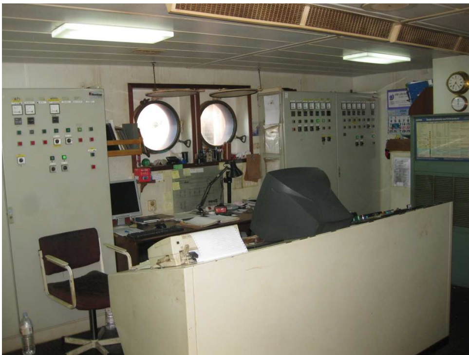
figura 7. Sala de control de máquinas
