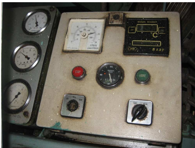
figura 22. Control local del MP
