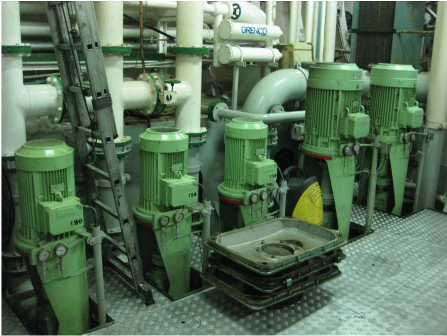
figura 35. Bombas centrífugas A/S
