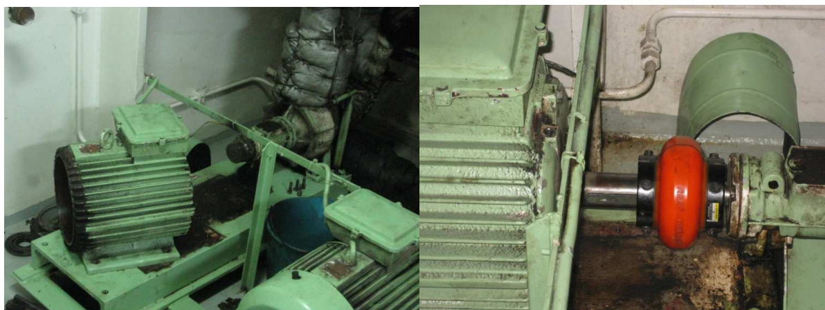
figura 47. Acoplamiento motor eléctrico-bomba de circulación aceite térmico
