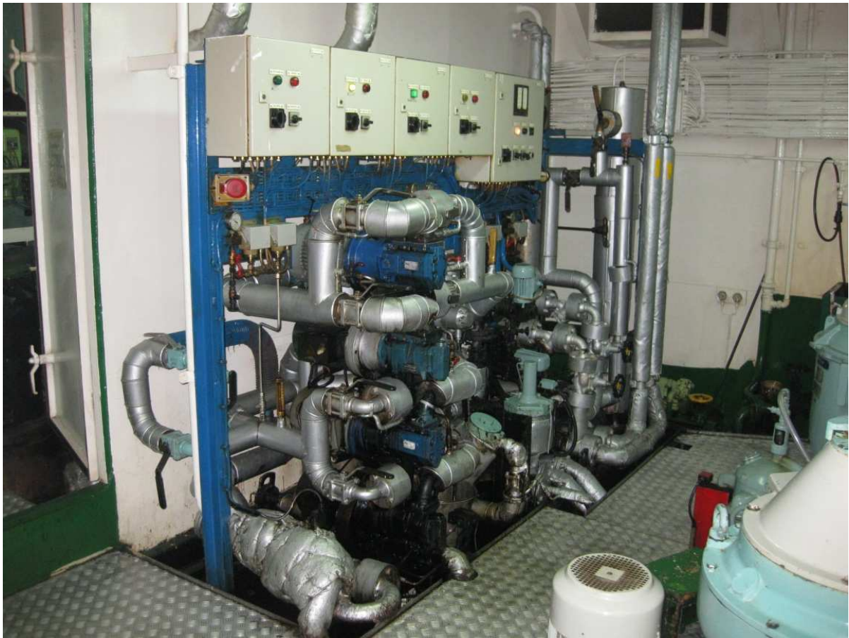
figura 25. Módulo de combustible
