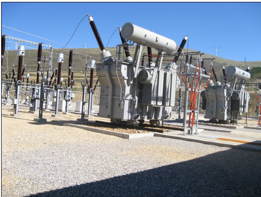
Figura J.4. Subestación (fuente: CETASA)
