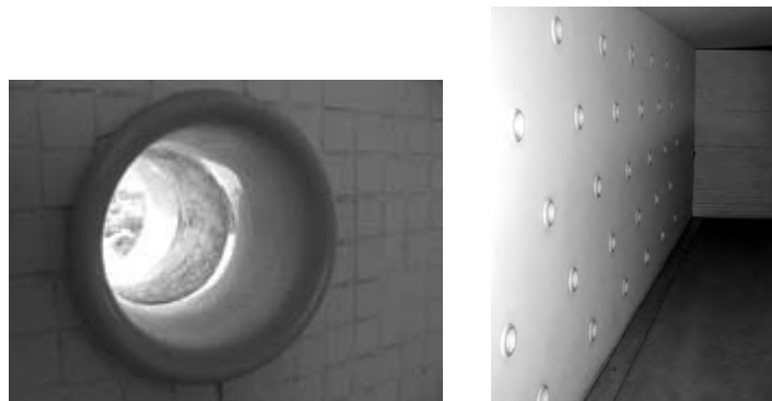
Figuras 35-36. Buzinotes en la pared de la rampa.
