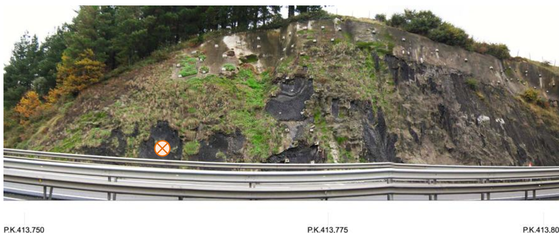
Figura 5.1.1. Talús comprès entre el PK 413,750 i el PK 413,800. La marca circular correspon al sondeig IM-13, realitzat en un tram argilític, d'on s'ha extret posteriorment la mostra IM-13, de la qual se'n ha fet un estudi textural (veure apartat 5.8).
