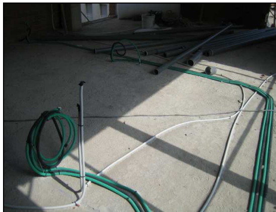
Foto 4.44: Calefacció i telecomunicacions
