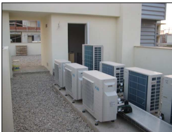
Foto 4.45: Maquinaria en coberta Aire-Acondicionat
