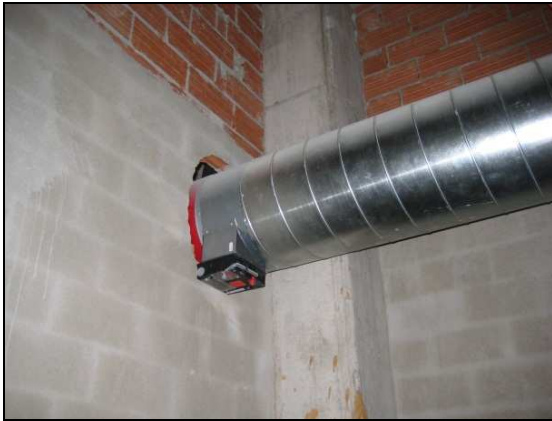
Foto 4.46: Conducte de vent. amb tallafoc
