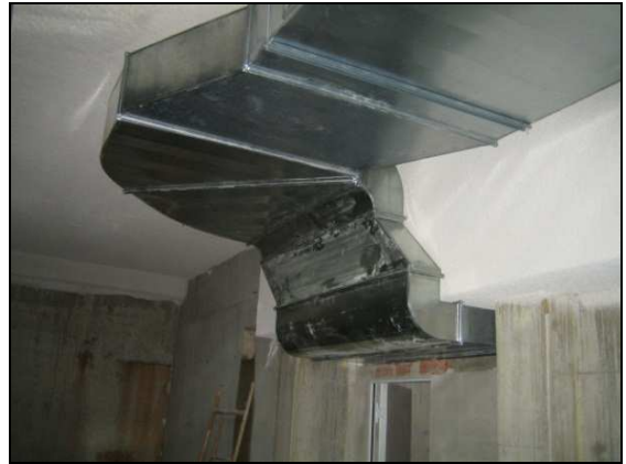
Foto 4.47: Conducte d'impulsió d'aire pàrquing
