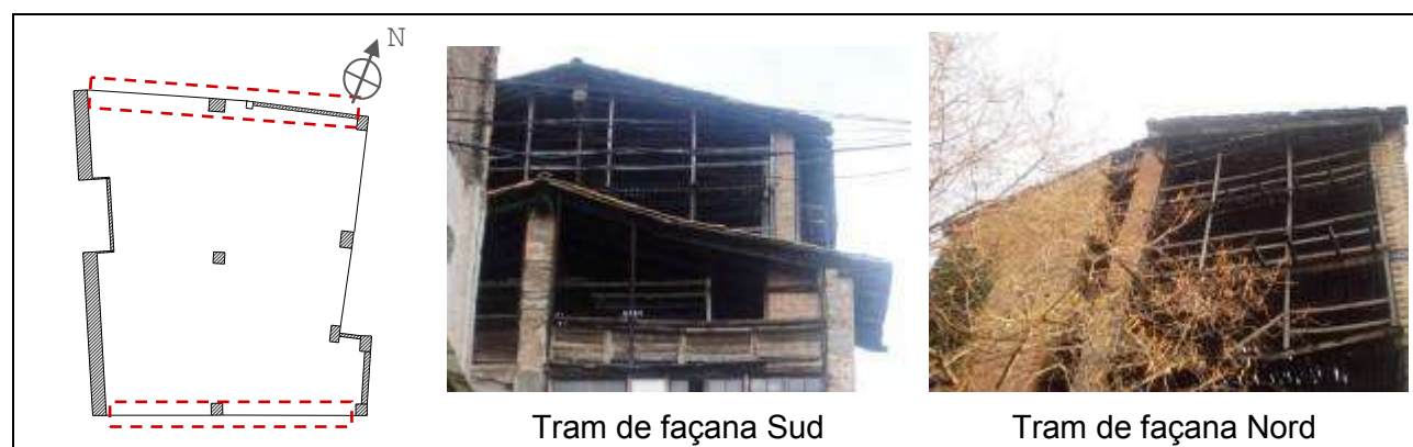
Figura 5.44 Façanes nord i sud de les plantes tercera a sisena, corresponent als assecadors. Són trams pràcticament sense tancament per permetre la corrent d'aire.
