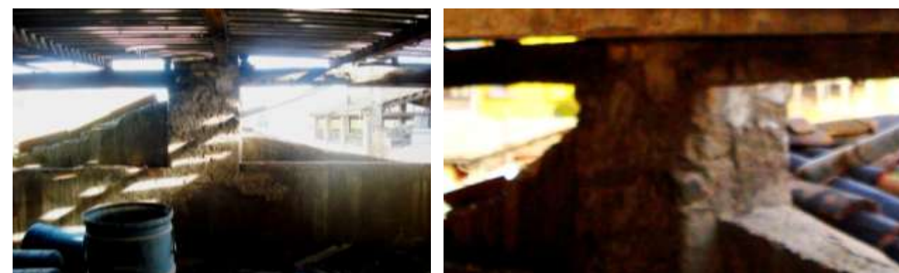
Figura 5.22 Detall B: Trobament de la coberta de l'Annex a la P3 de La Tuta
