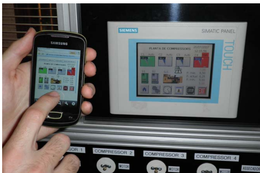
Fig. 12. Foto control remot mitjançant un telèfon mòbil.
