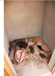
Letrinas en mal estado
