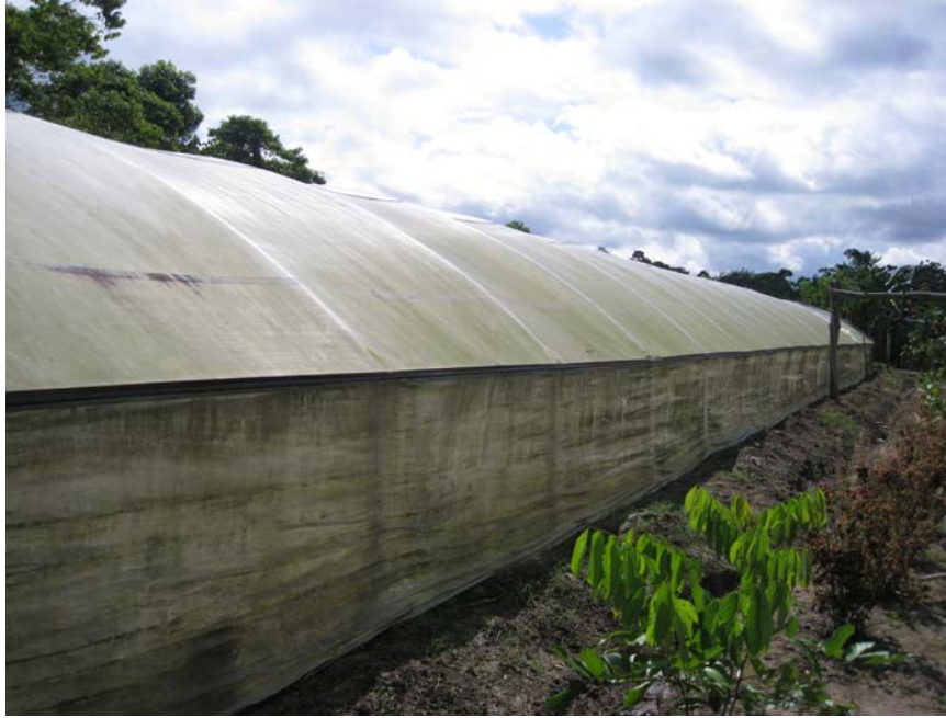
Imagen 5.3.1.2.2.: Estructura del invernadero.
