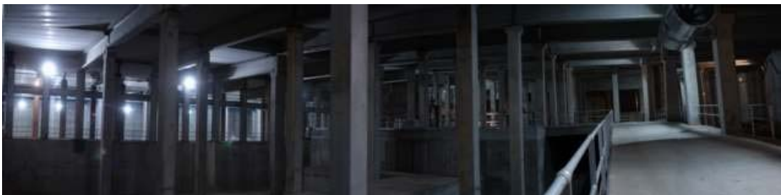
Instal·lacions de la depuradora del Besòs
