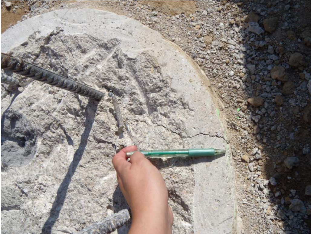
Figura 2.4: Fisura en un pilote descabezado, donde no se pueden obtener resultados de ensayo.
