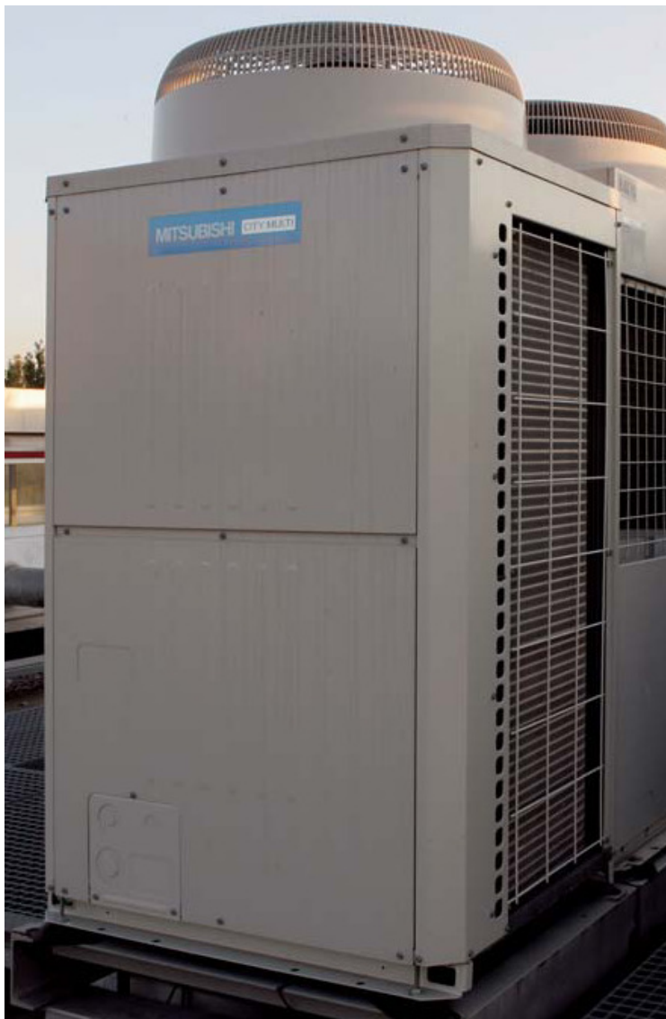
Detalle unidad exterior.
