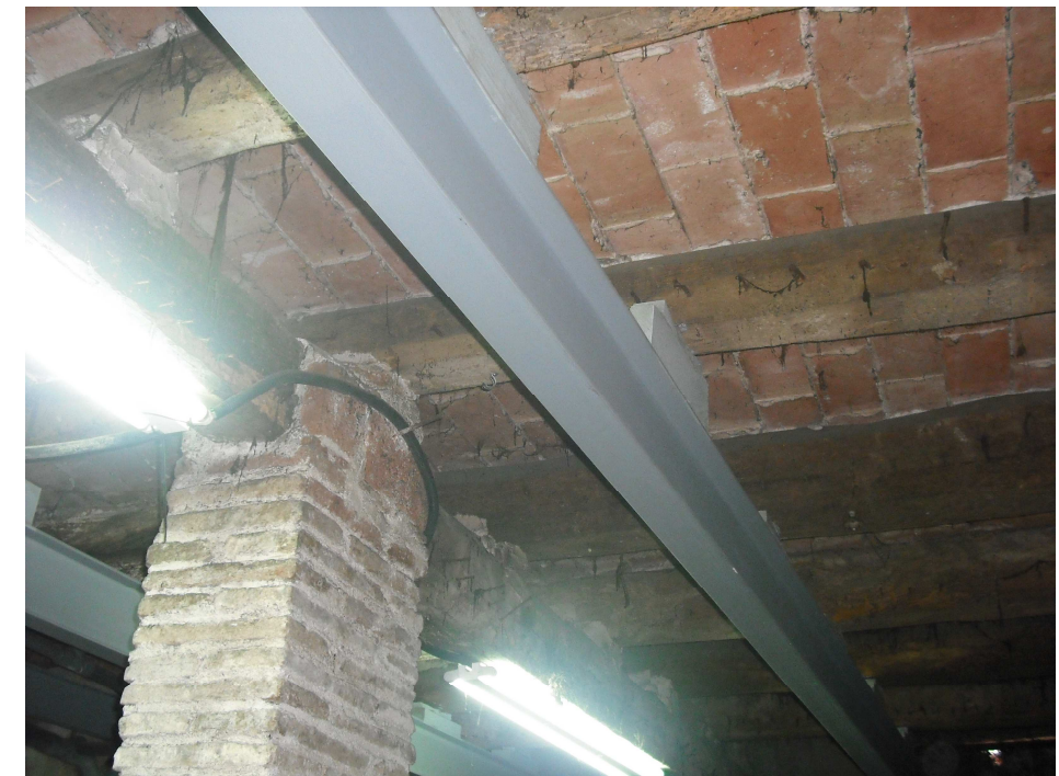
39. Reforç estructural amb bigues IPN100 en una rehabilitació d'aproximadament de fa 30 anys segons hem va comentar l'arrendatari
