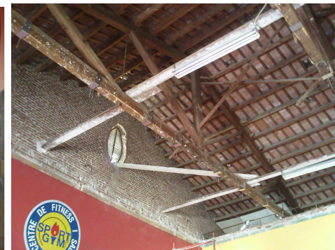
7. Fotografia feta mentre es realitzava un canvi en el sostre tècnic a primera planta. Des de un punt de vista estètic podria ser interessant prescindir de sostre tècnic
