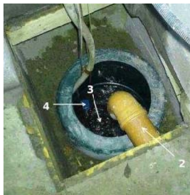
Imagen 29: Depósito de ventilación
