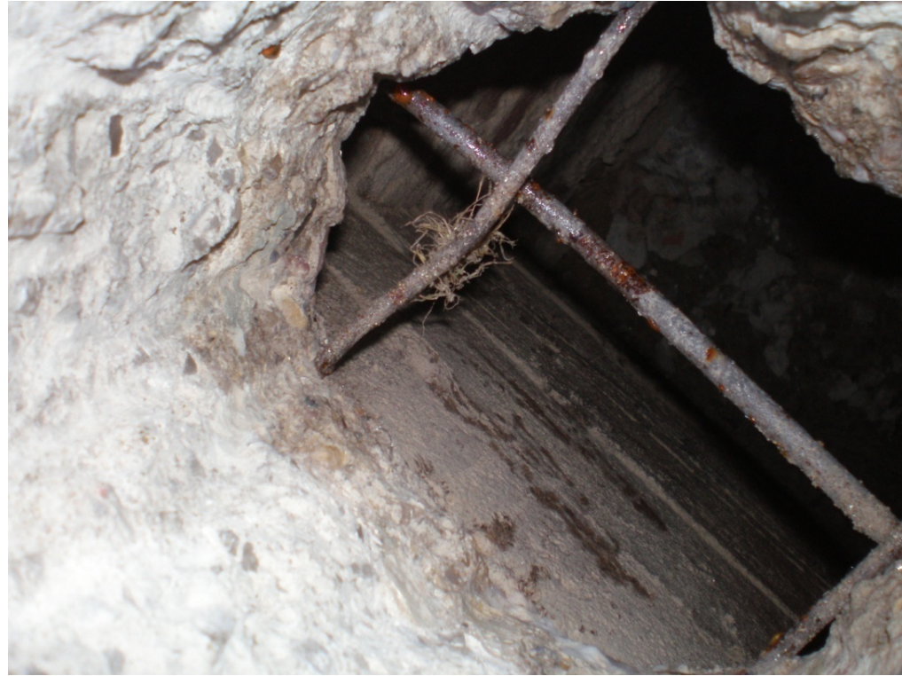
S'aprecia amb la corrosió en l'armadura. Destacar també que aquesta no té corrugues i el diàmetre de l'armadura principal és de 14 mm i de l'armadura de repartiment de 10 mm.
