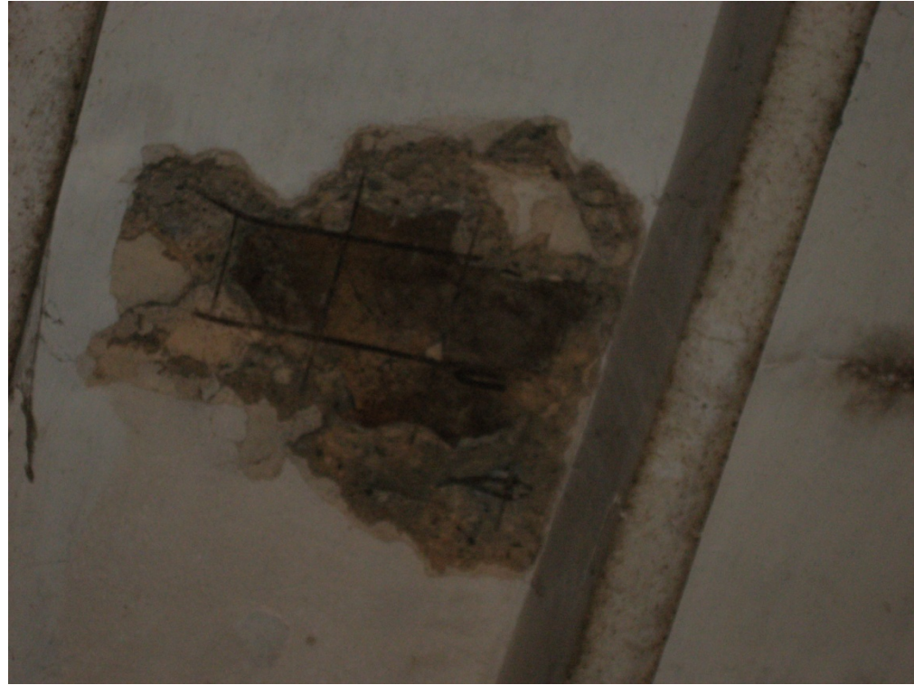
L'armat de la llosa presenta importants problemes de corrosió
