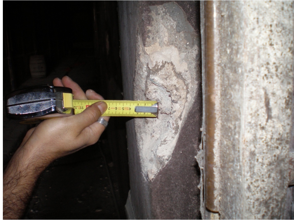
En aquesta fotografia es pot comprovar el recobriment de les armadures.
