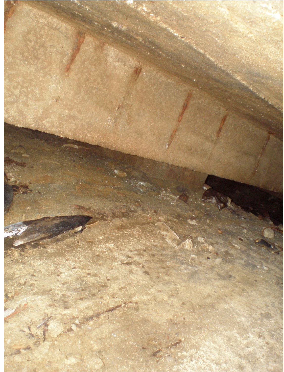
S'aprecia clarament la corrosió en l'armadura, concretament els cercols de bora de la jàssera pateixen un avançat estat de corrosió.
