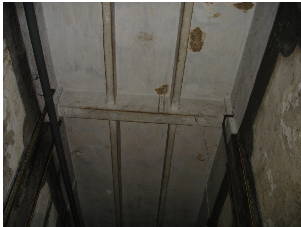
Diversos despreniments en la llosa.
