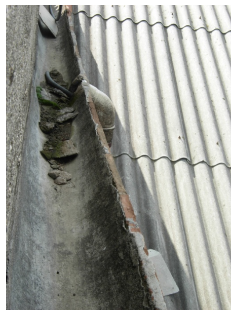
Manca de manteniment canals
