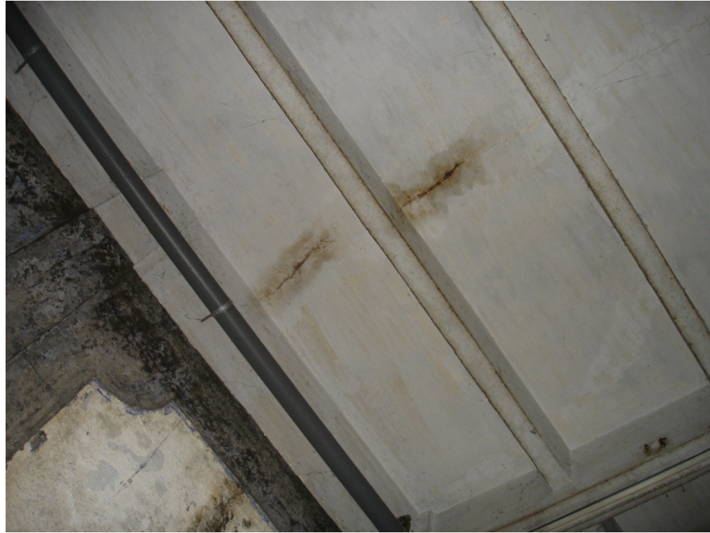
La llosa de formigó patint unes importants esquerdes
