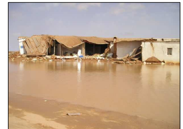
Fotografia 11: Restes d'un altre edifici enrunat per les pluges torrencials
