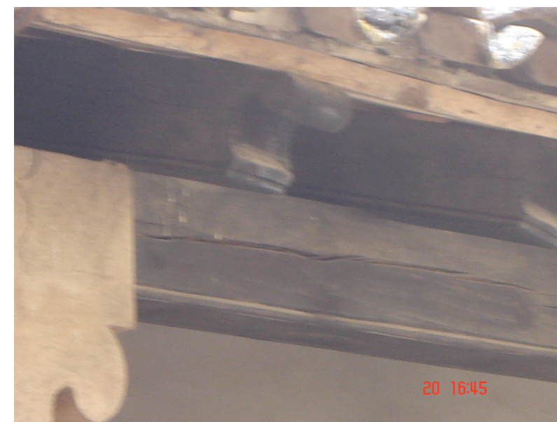
Imágenes de las clavellas que han aparecido en las vigas de madera que sustentan la cubierta de la galería. Podemos ver que las fisuras son paralelas a las fibras como hemos mencionado anteriormente.
