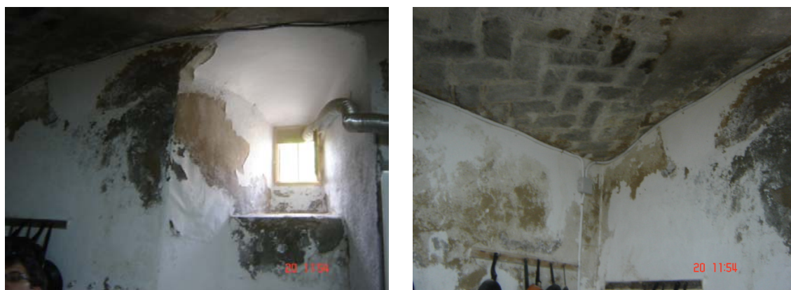
Imágenes donde se muestra las humedades de filtración aparecidas en la zona de la cocina del restaurante. Como se puede observar han hecho saltar el revestimiento de la pared.
