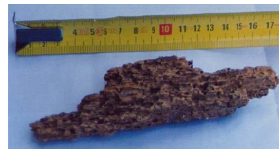
Detalle de una parte del mobiliario interior del castillo que se ha desprendido por acción de las termitas, con influencia, también, de la pudrición por humedad.
