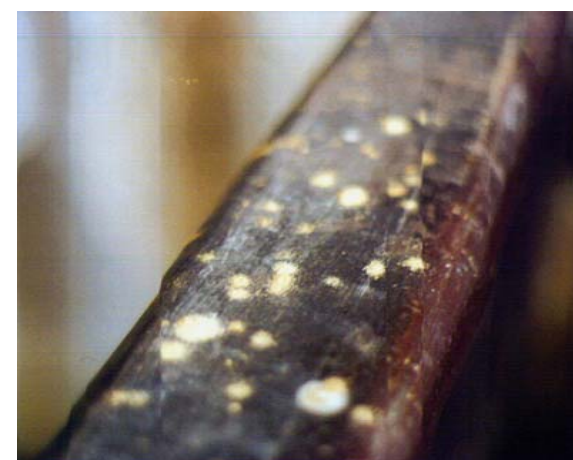
Barandilla del interior del castillo atacada por la carcoma.
