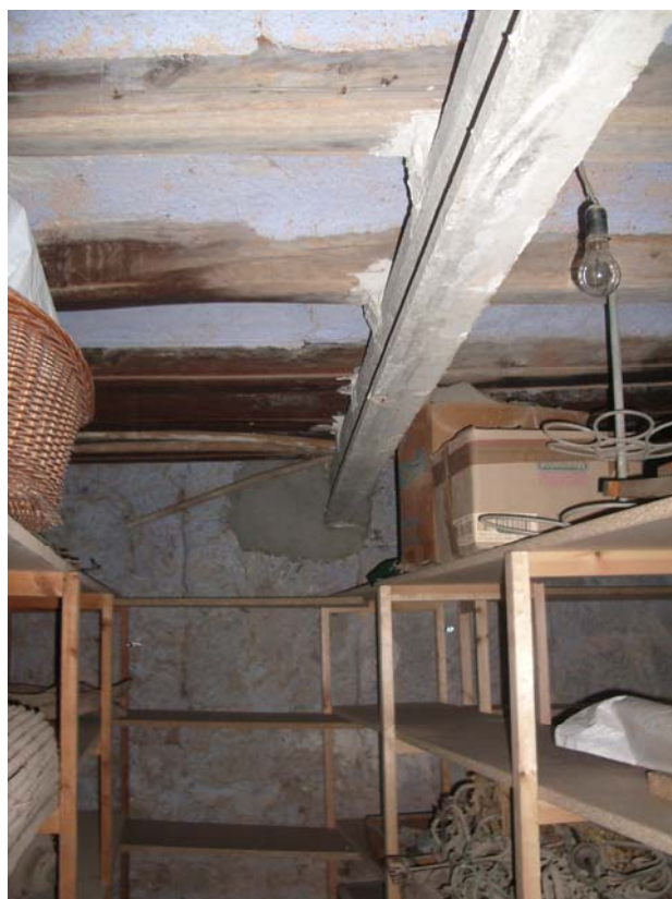
Vigas de madera situadas en la planta baja, concretamente en el trastero 2. Podemos ver en la fotografía la viga prefabricada de hormigón que actúa como viga corta luces.
