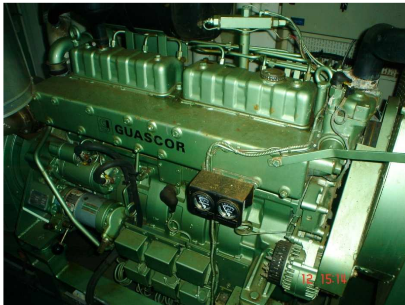
Fig1: Vista del generador de emergencia
