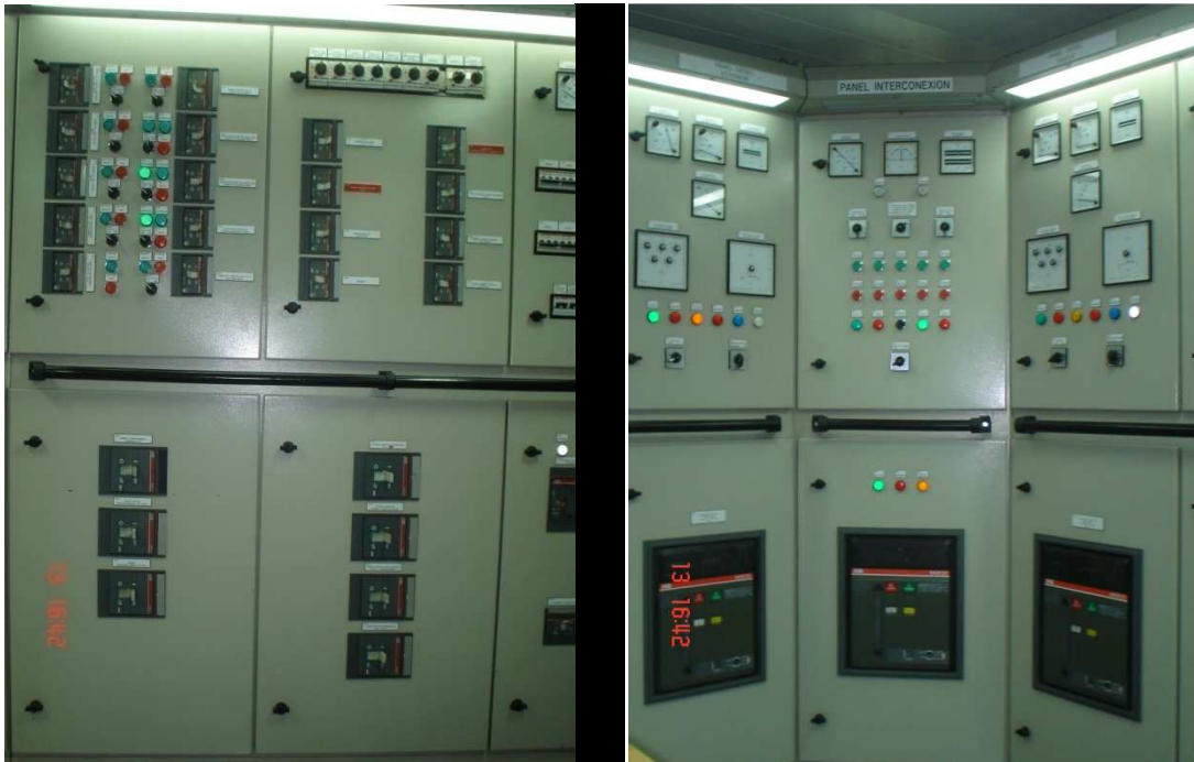
Fig. 27: Los cuadros eléctricos principales
