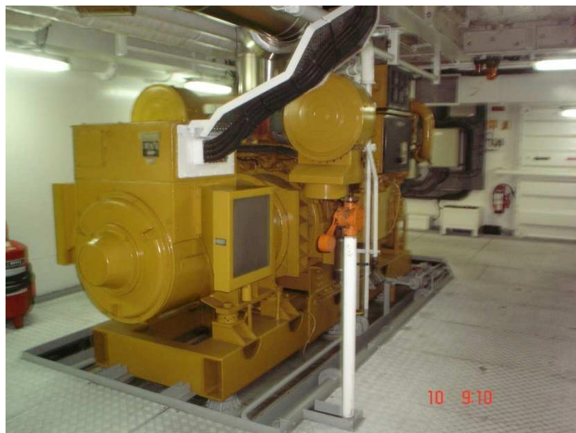
Fig. 26: Vista de uno de los motores auxiliares
