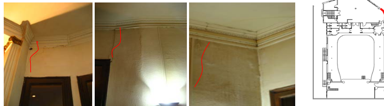
Esquerdes i fissura a la paret de façana per l'interior.
