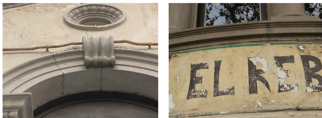
Esquerdes i fissura a l'obertura de façana
