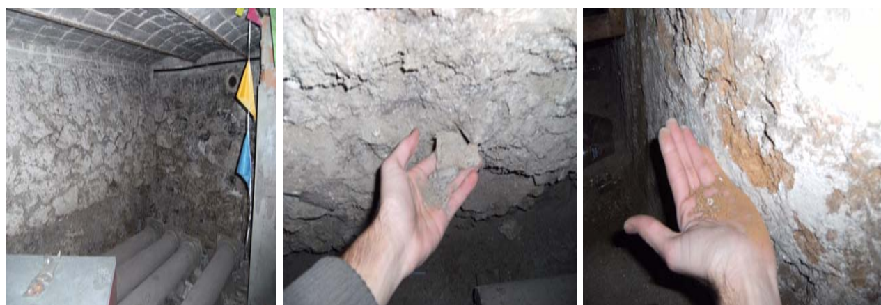
Humitat i despreniment a la paret de pedra
