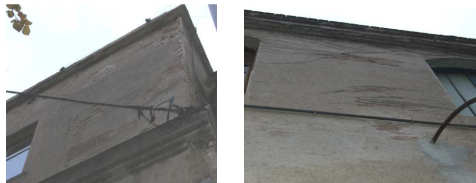
Disgregació de l'acabat de la façana.
