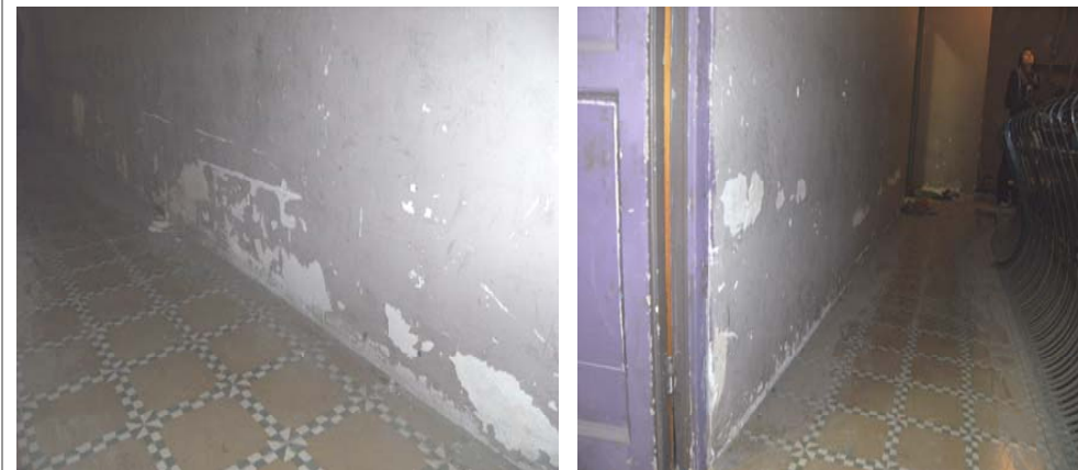
Disgregació de l'acabat de la paret de totxo.
