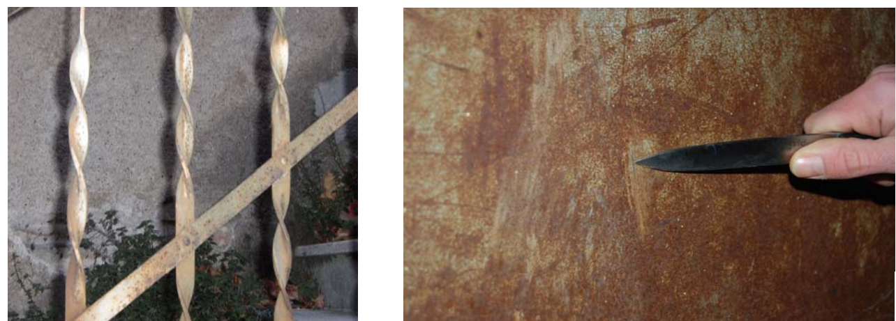
Corrosió - oxidació dels elements metàl·lics
