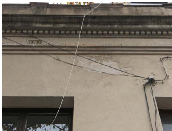
Disgregació de l'acabat de la façana.
