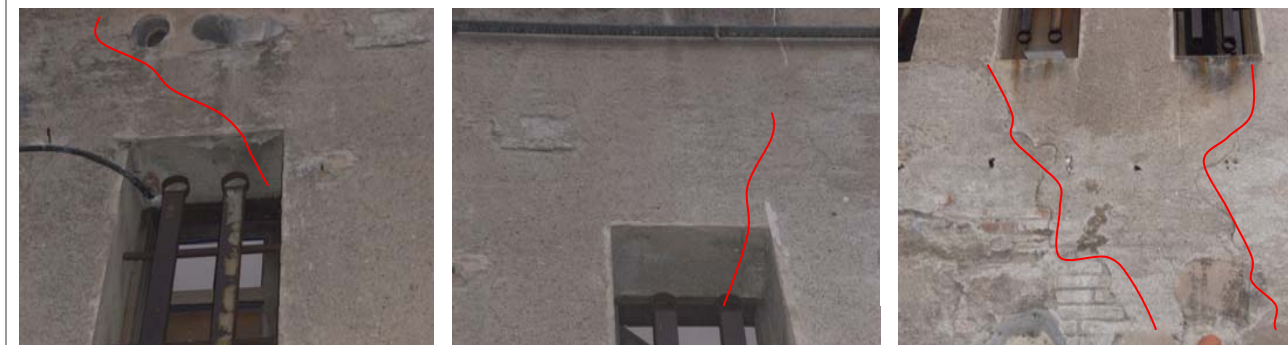
Esquerda i fissures de façana a la zona d'obertures
