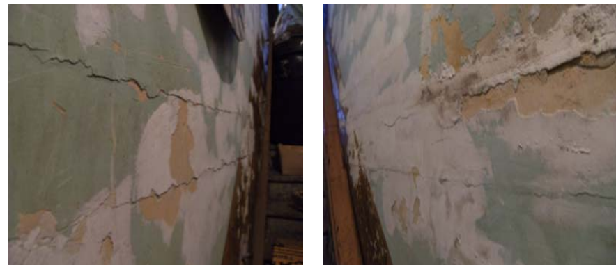
Esquerdes a nivell de forjat a la paret de totxo.
