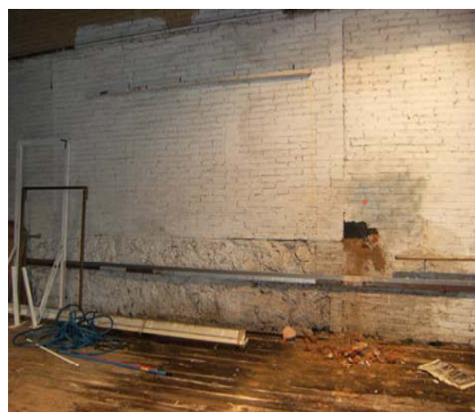
Humitat a la paret de maçoneria
