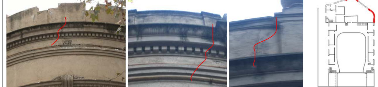
Fissura a l'arc de la finestra.
