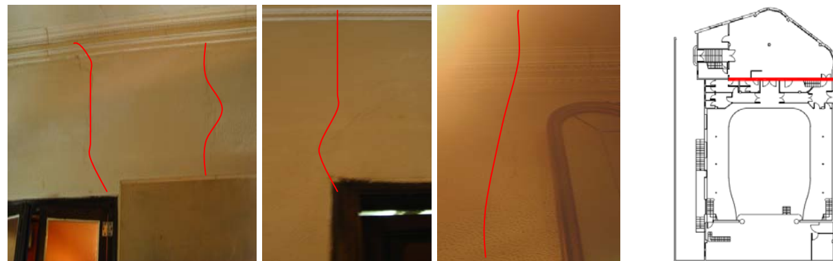
Esquerdes i fissures a la paret de càrrega de totxo
