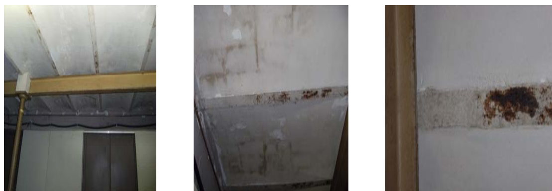
Corrosió – oxidació dels perfils metàl·lics
