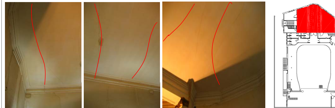
Fissures i esquerdes al fals sostre.
