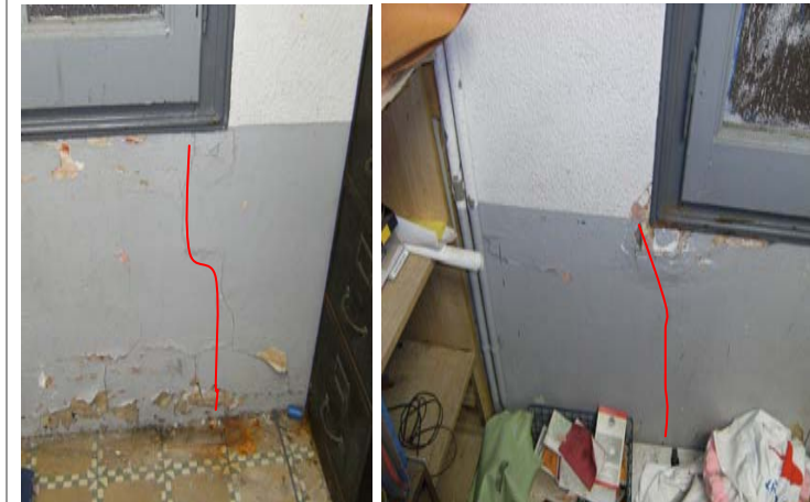
Esquerdes a la paret de façana
