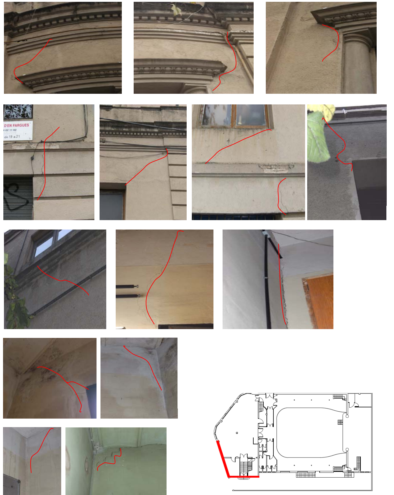
Esquerdes inclinades a la paret de façana.
