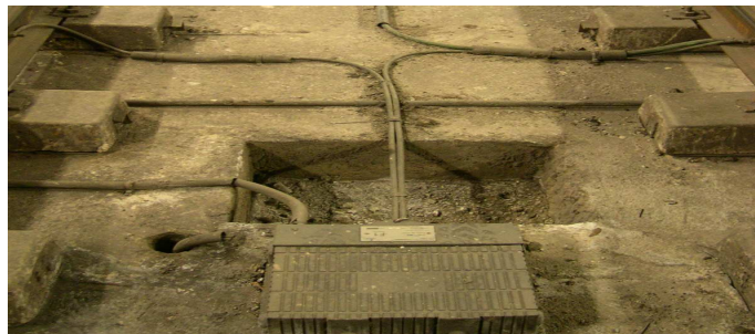
Fig 14. Unitat de sintonia fixada a terra.
