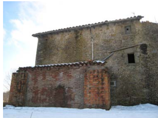
Maons presents al mur de fàbrica del dipòsit situat a la façana nord
