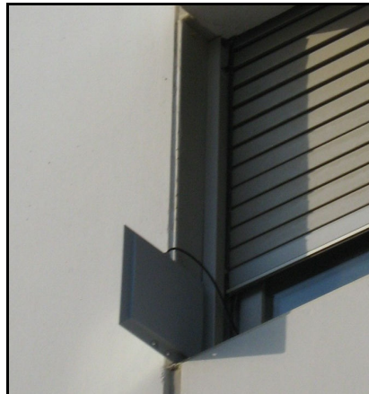
Fig. 2.10 Antena del node central a la finestra del laboratori 123P frontal amb l'edifici del CTTC al Campus del Baix Llobregat
