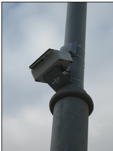
Fig. 2.4 Node repetidor amb l'antena a la part superior instal·lat a la farola
