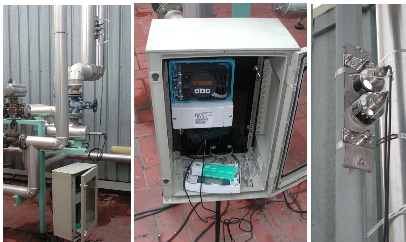
Fig. D.4 Imatges de la instal·lació del comptador mòbil ultrasònic PROSONIC FLOW P 90 de Endress+Hausser a les línies de retorn de condensats.
