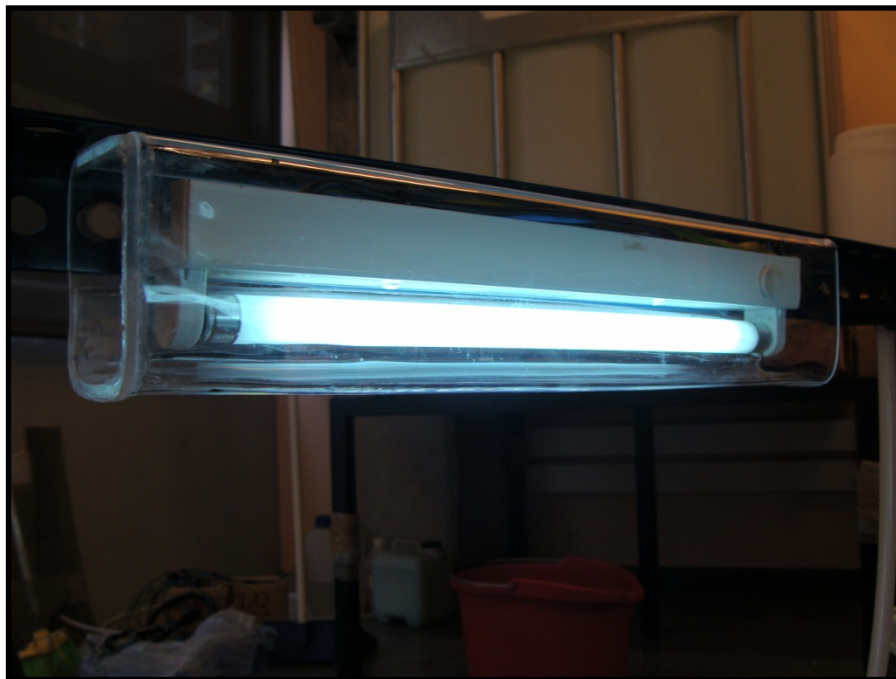
Fig. 39 Detall de la mampara protectora dels fluorescents
