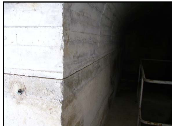
Figura 4.17 - Movimiento de la junta longitudinal de la presa de Rumedo
