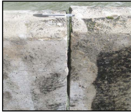
Figura 4.15- Movimiento relativo entre dos bloques de San Esteban
