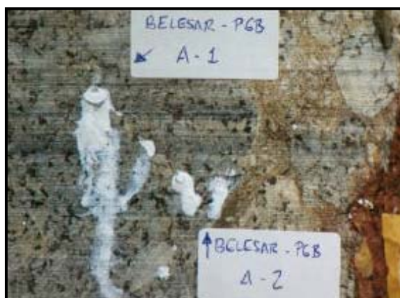
Figura 4.9- Gel producto de la reacción en la presa de Belesar, (Herrador,2002)
