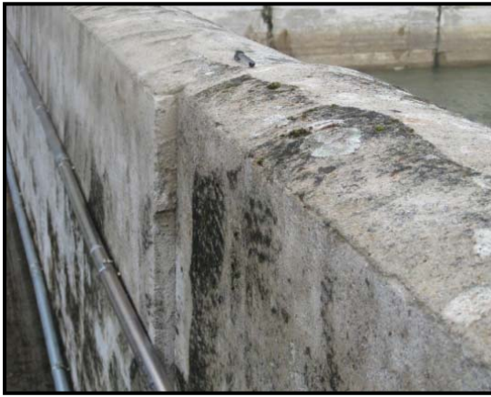
Figura 4.14- Movimiento relativo entre dos bloques de San Esteban
