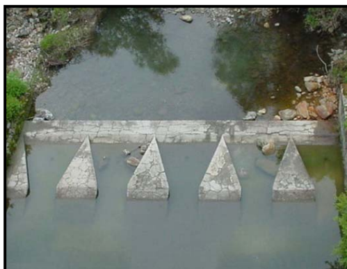
Figura 4.3- Dientes de pie de presa con fisuración enramada (Araújo, 2008b)
