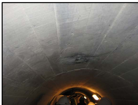
Figura 4.8 Fisura en la parte más alta de la galería
