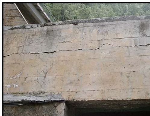
Figura 4.4- Fisura horizontal en el acceso a la galería de Graus (Araújo, 2008b)
