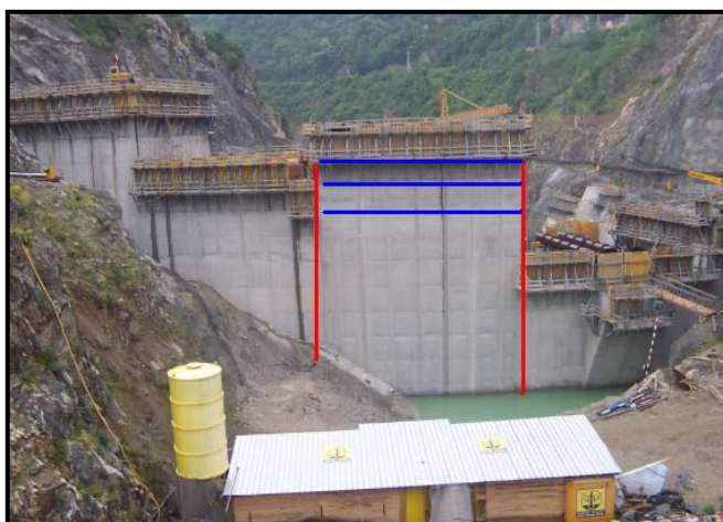
Figura 5.11- Presa en construcción donde se observan, en rojo, las juntas de bloques y, en azul, las juntas longitudinales. (Pujol, 2008)
