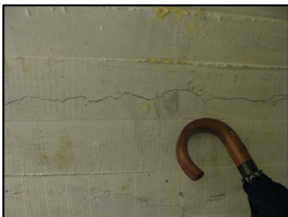
Figura 4.7- Fisura en un paramento de galería
