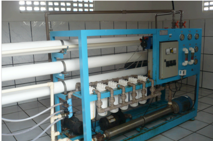
Figura 31: Sistema de desalinización por membranas de osmosis inversa instalado en la comunidad de Impueiras. Fuente: Archivo de fotos propias.
