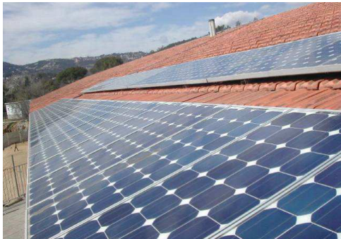
ELEMENTO SOBREPUESTO EN TEJADO.
