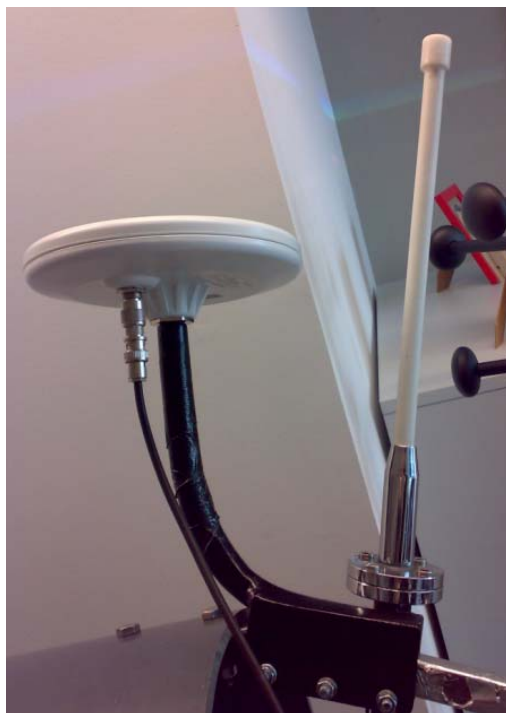
Figura 4.21 Antenas colocadas en el elemento autosoportante
