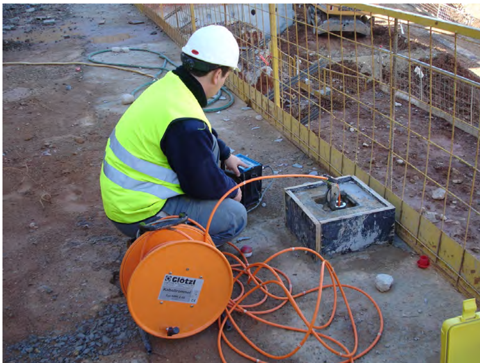
Figura 4.1. Presa de dades d'un inclinòmetre.
