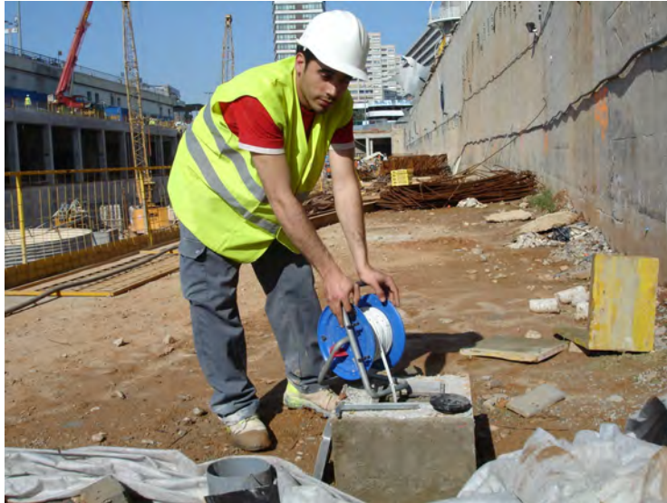
Figura 4.8. Presa de mesures en un piezòmetre obert (hidronivell).
