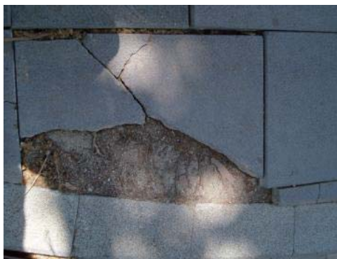
Fig 11: Paviment en mal estat a l'Avinguda de la Pineda
