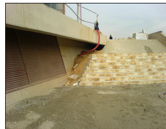
Imatge 5.56: Trobament entre l'escala i la façana de la PCAC.
