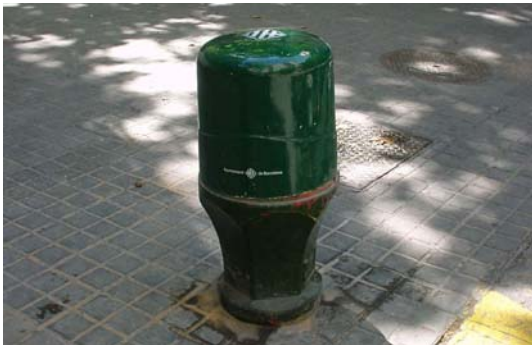
Figura 2. Hidrant d'extracció d'aigua del subsòl.
