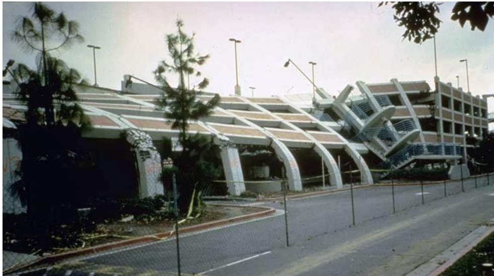
Figura 2.22 Parking de la universitat de Califòrnia després del terratrèmol. (foto: M. Celebi, U.S. Geological Survey)
